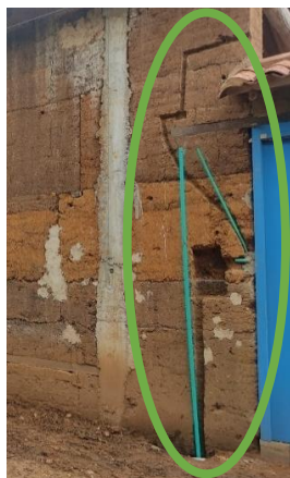
Figura 42. Tubería en PVC.
