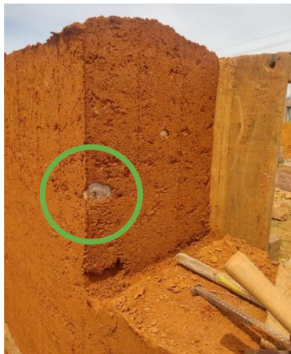
Figura 24. Trozo de madera expuesto.
