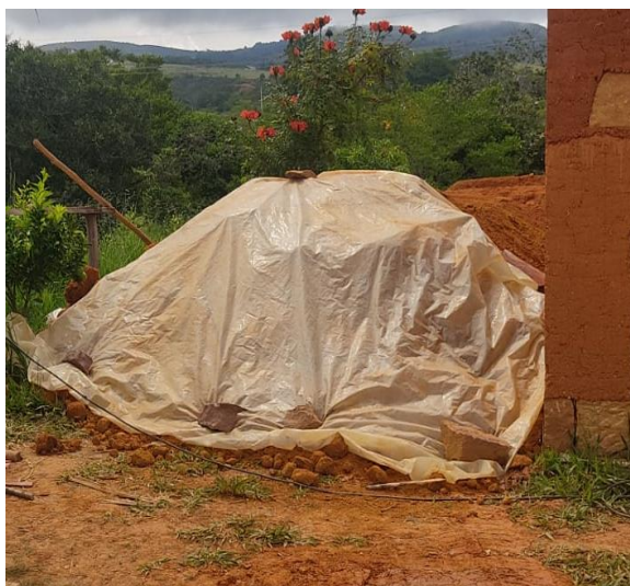
Figura 1. Acopio de material cubierto.
