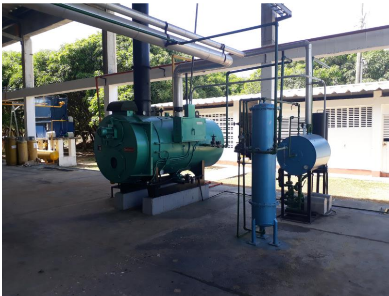
Figura 24. Caldera Continental de 60 BHP y sistema de alimentación de agua. Fuente: autor.
