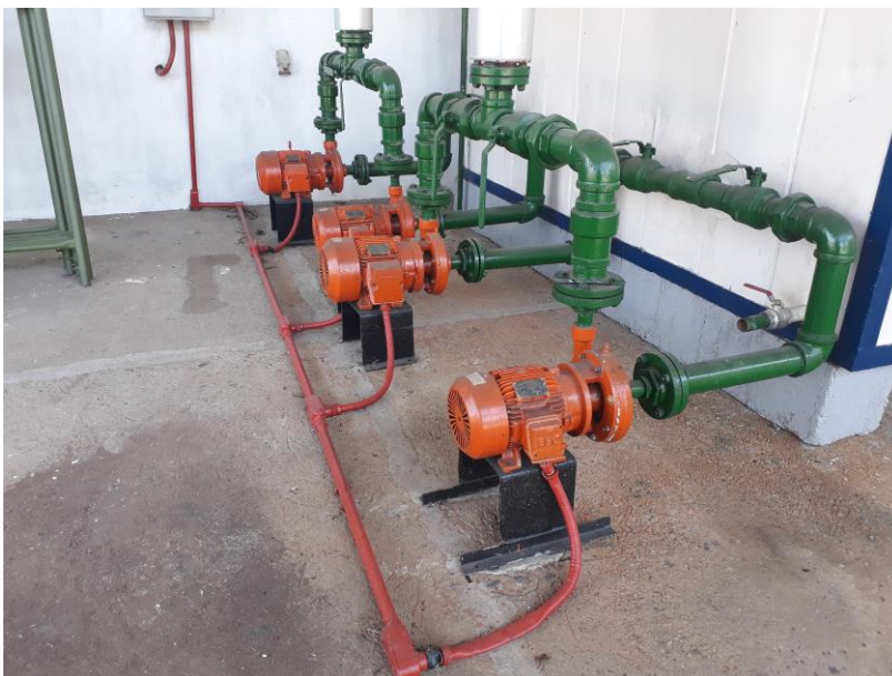
Figura 14. Motobombas encargadas de impulsar el agua fría del banco de hielo. Fuente: autor.
