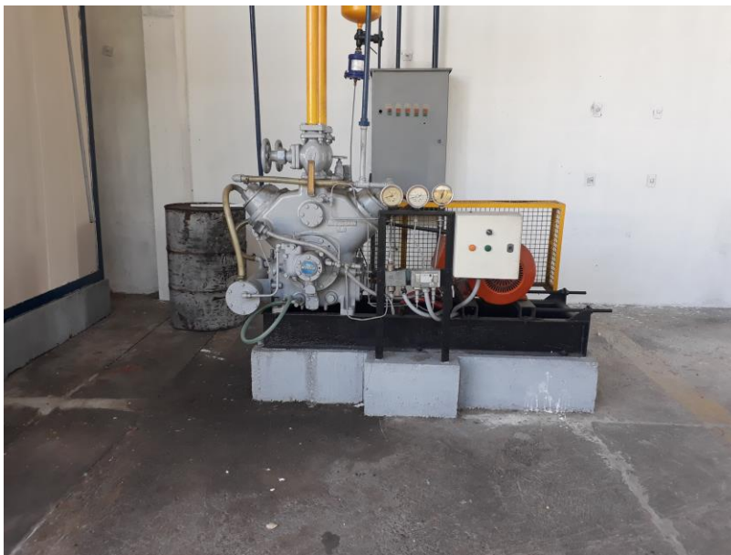
Figura 7. Compresor de amoniaco MYCOM con motor siemens de 30 hp. Fuente: autor.
