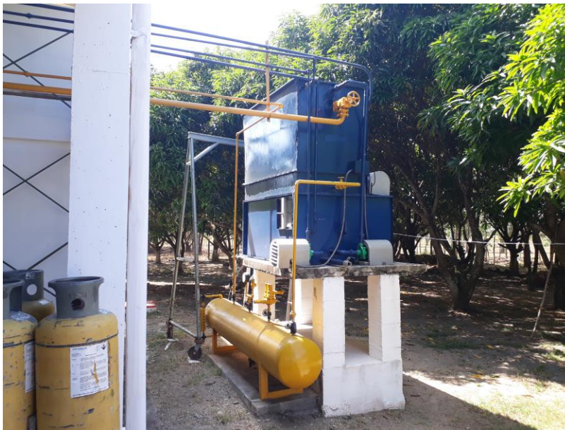
Figura 8. Torre condensadora de amoniaco. Fuente: autor.
