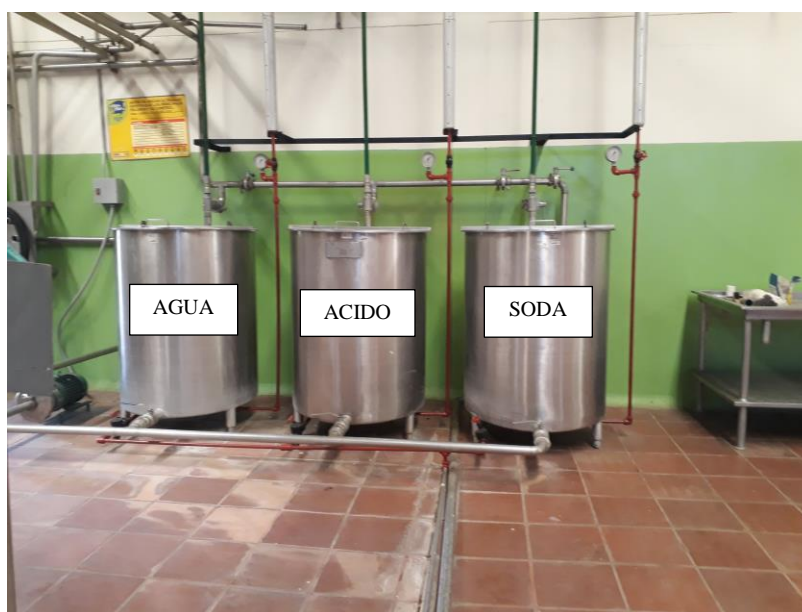
Figura 22. Tanques de lavado CIP con sus diferentes componentes. Fuente: autor.
