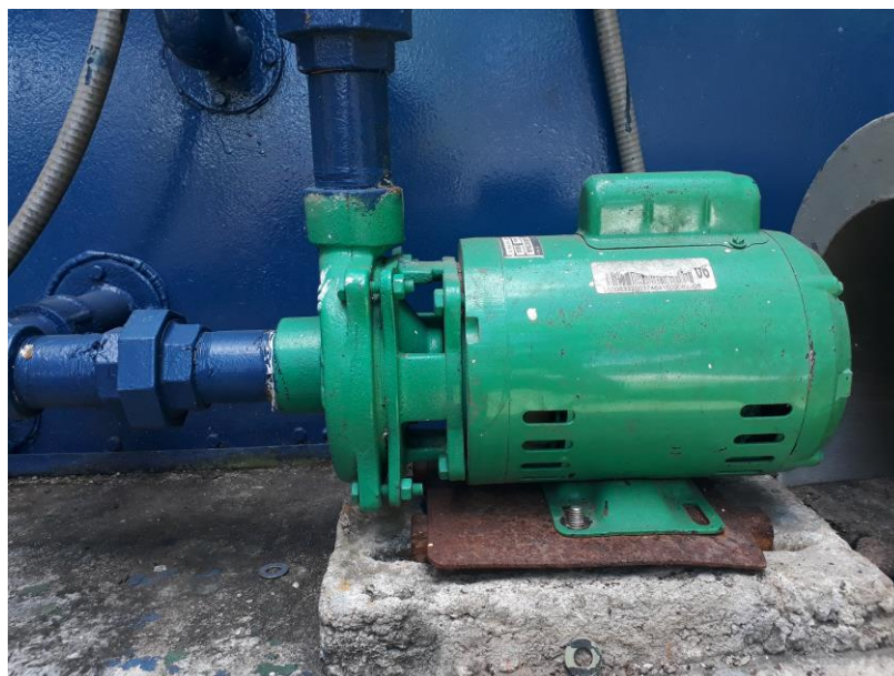
Figura 9. Motobomba encargada de rosear la tubería que transporta amoniaco. Fuente: autor.
