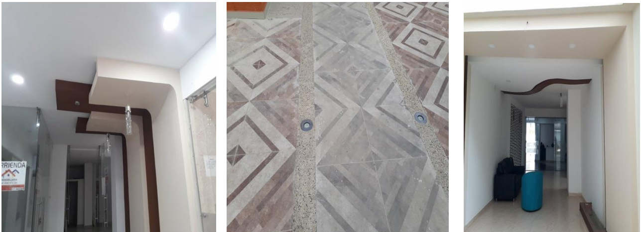
Figura 27. Luminaria de la Zona Social del Edificio San Agustín Torre Club
