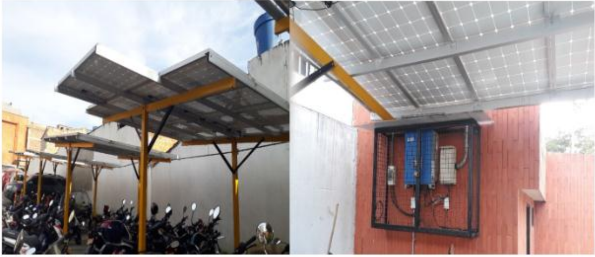
Figura 23. Sistema Solar implementado en el hospital Emiro Quintero Cañizares
