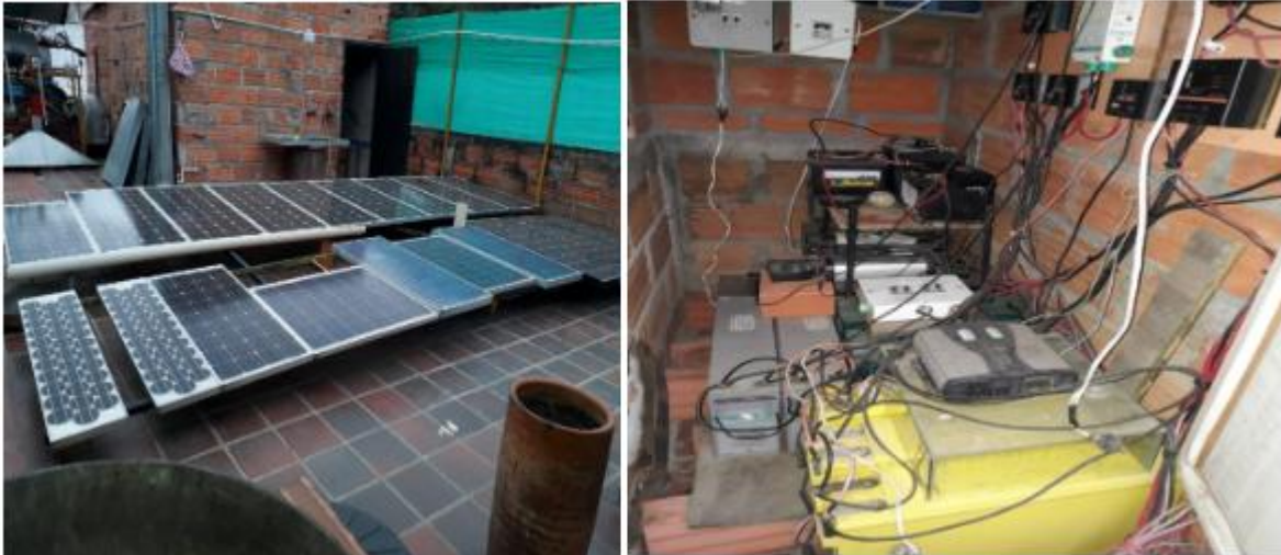
Figura 26. Sistema Solar Instalado en el Barrio El Palomar
