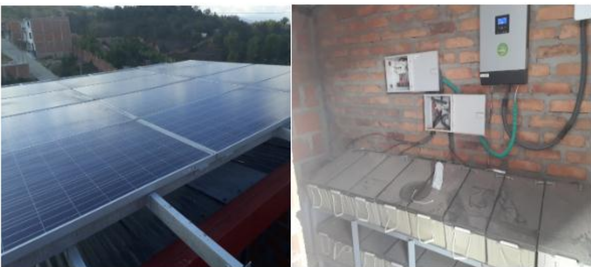
Figura 25. Sistema Solar Implementado en el Barrio Landia
