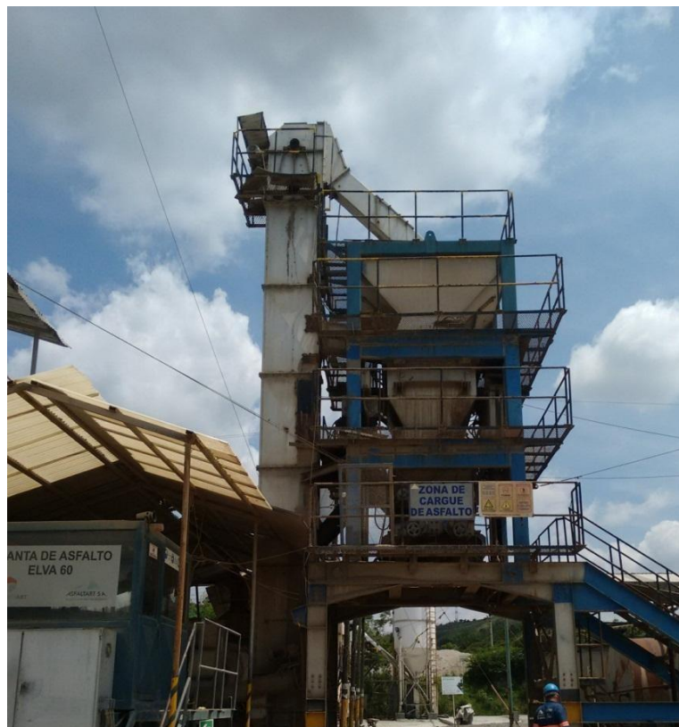
Figura 15. Planta de Asfalto ELVA 60.
