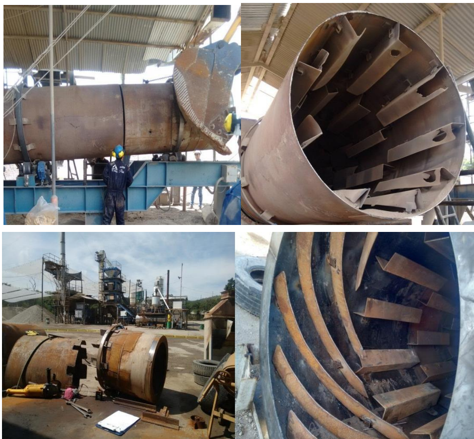
Figura 26. Imágenes del trabajo realizado en el tambor secador donde se evidencia claramente el desgaste de las piezas.
