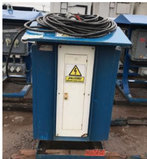
Figura 6. Transformador Fuente. Pasante
