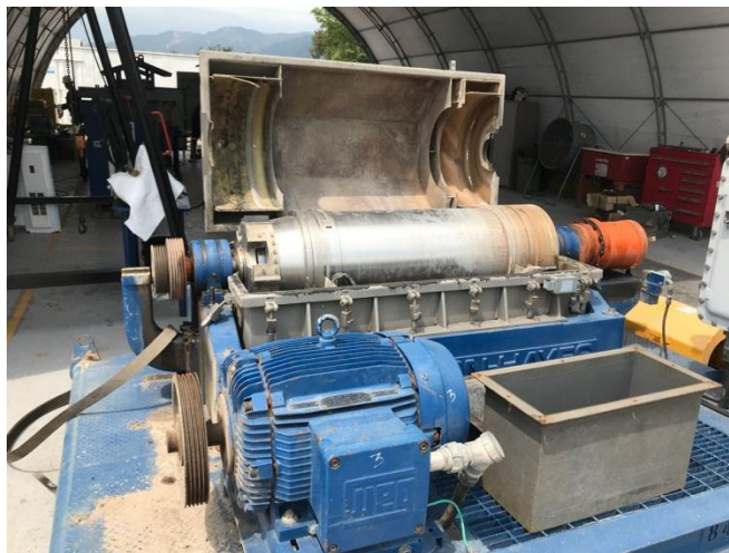
Figura 3. Realización de prueba de funcionamiento a centrifuga Fuente. Pasante
