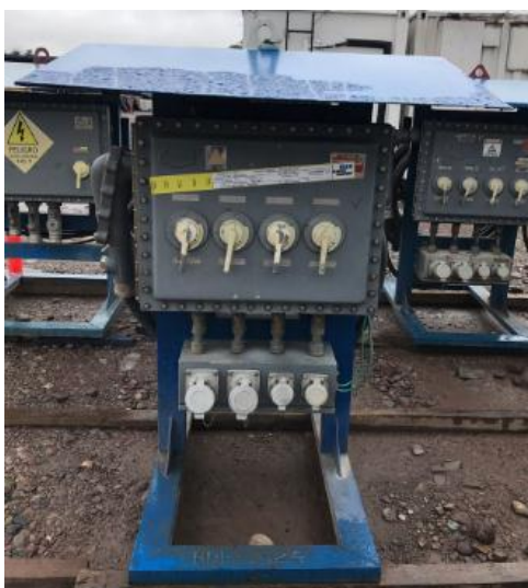
Figura 5 tablero eléctrico en pruebas de funcionamiento Fuente. Pasante
