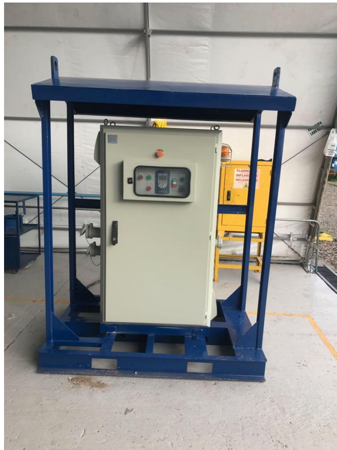
Figura 4. Variador de velocidad Fuente. Pasante
