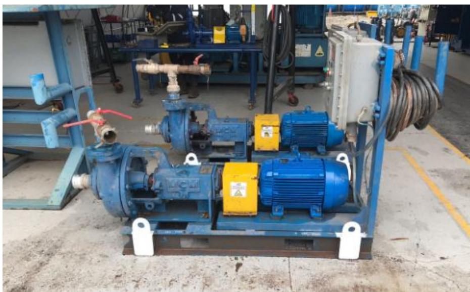
Figura 11. Bomba centrifuga en pruebas de funcionamiento Fuente. Pasante
