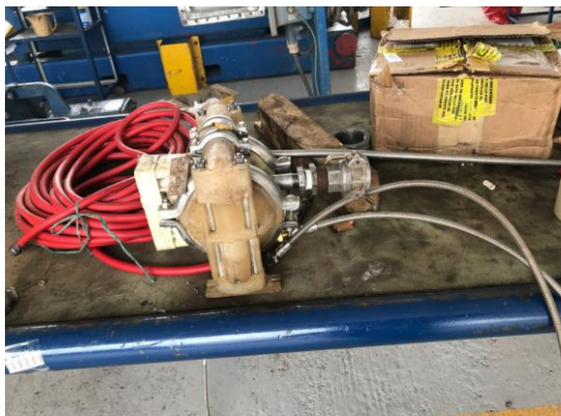
Figura 13. Bomba de aire P1 en prueba de funcionamiento Fuente. Pasante
