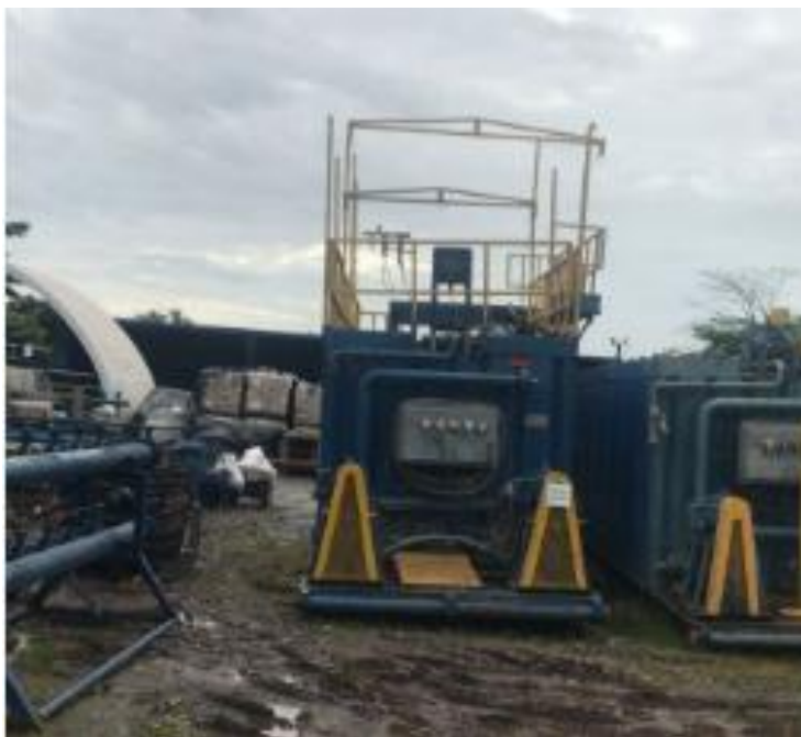
Figura 10. Unidad de tratamiento de agua en inspección Fuente. Pasante
