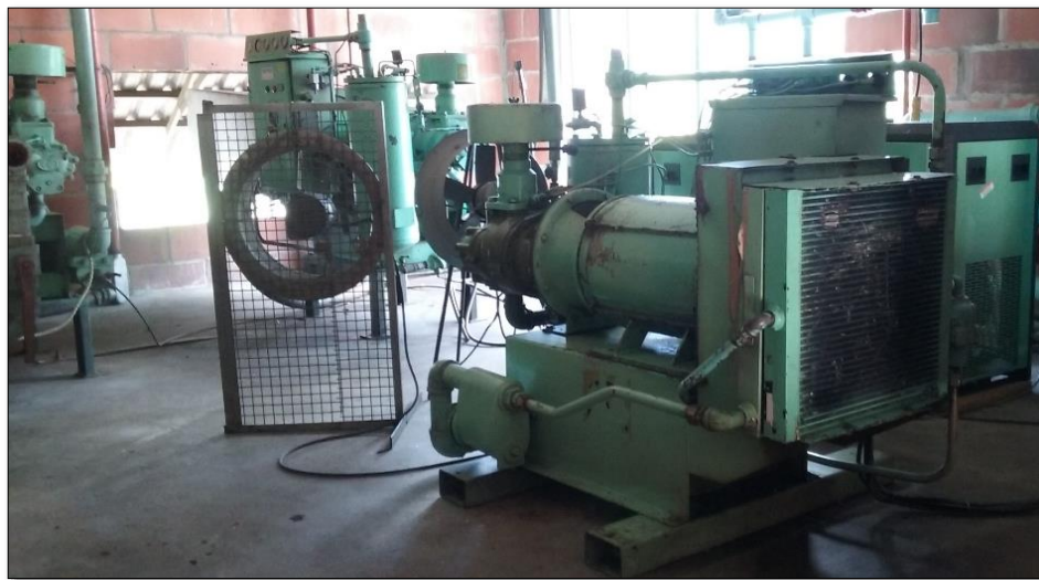
Figura 10. Compresor Sullair Nota fuente: Autor del proyecto
