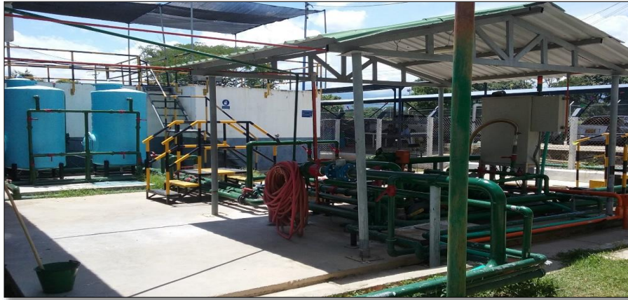
Figura 11. Planta de tratamiento de agua potable. PTAP Nota fuente: Autor del proyecto
