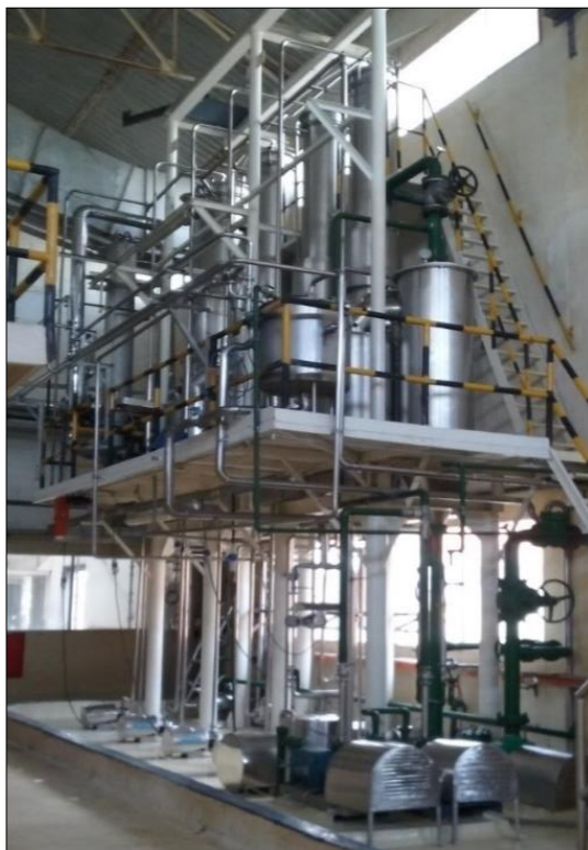
Figura 6: Evaporador de cuatro efectos Anhydro
