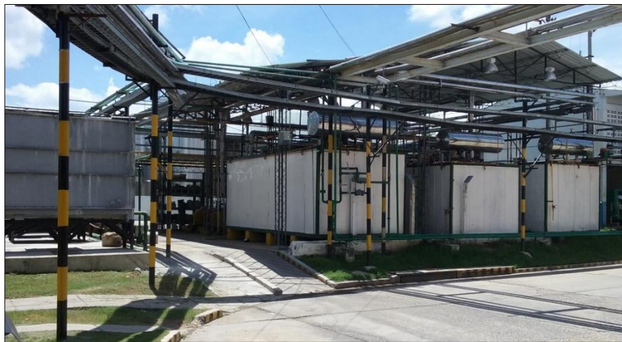
Figura 8. Área Generación de agua helada Nota fuente: Autor del proyecto
