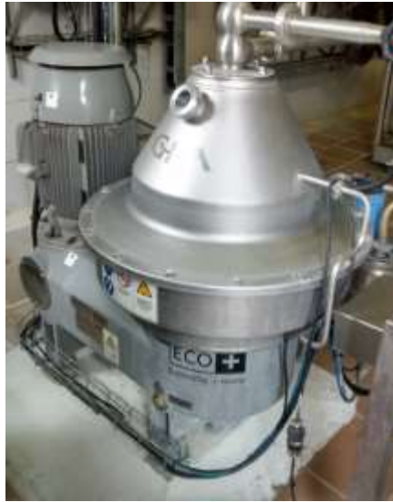
Imagen 4. Clarificadora Wesfalia Planta Freskaleche
