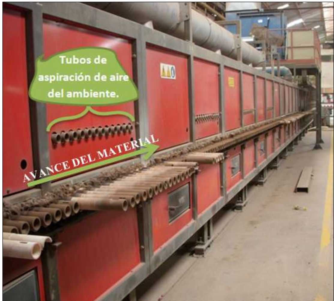
Fotografía 24. Zona de enfriamiento indirecto.
