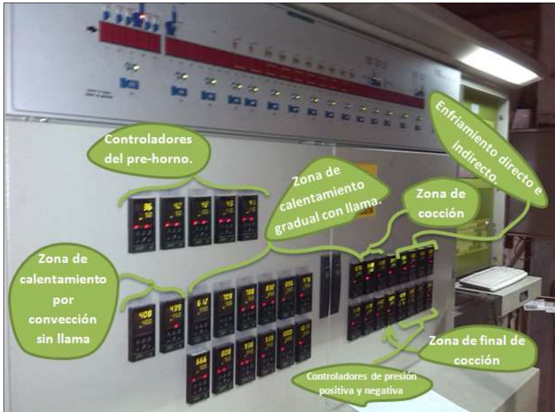
Fotografía 16. Controladores de temperatura y presión.
