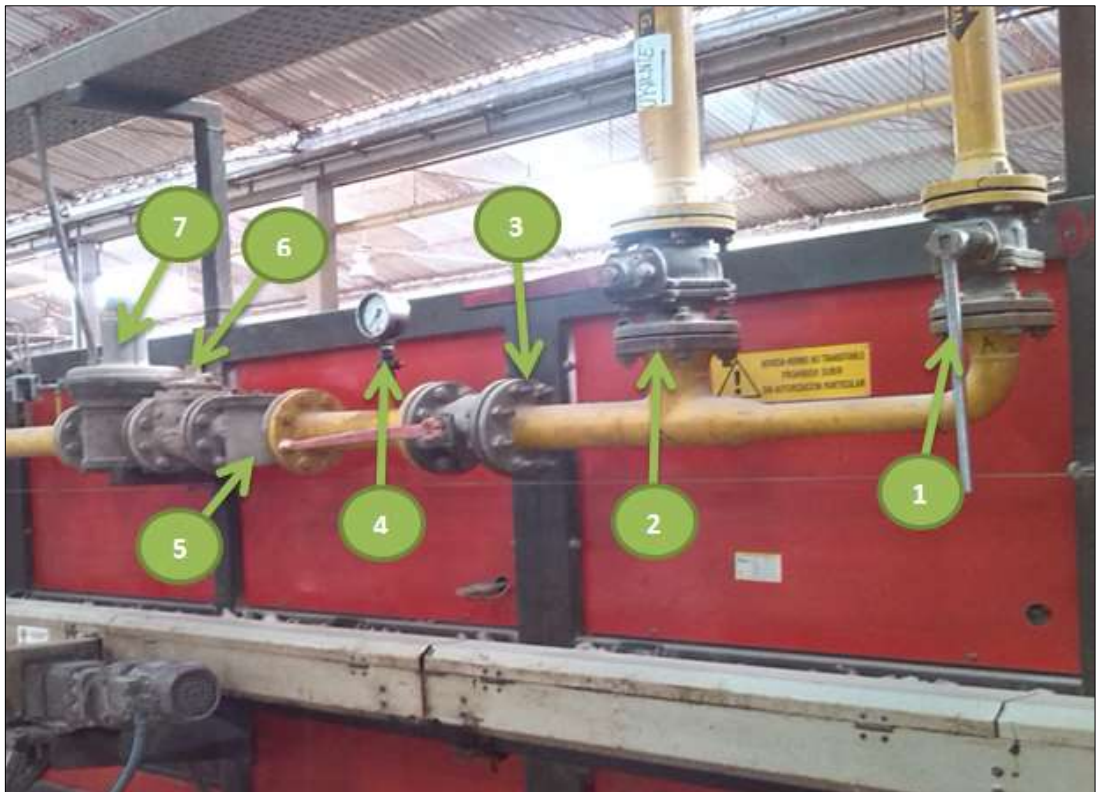
Fotografía 2. Grupo de regulación y control de gas.
