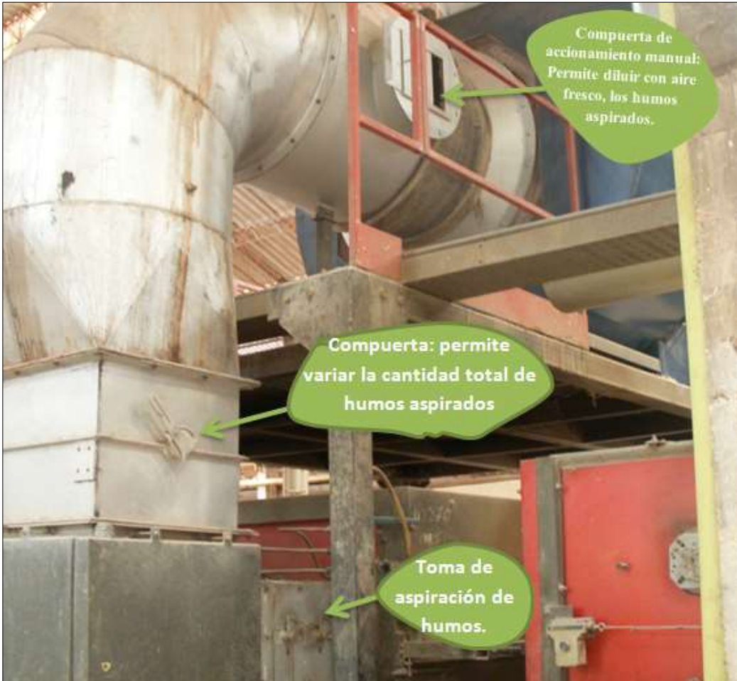
Fotografía 6. Aspiración de Gases de Combustión.
