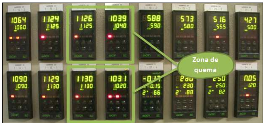
Fotografía 28. Controladores de la zona de quema.
