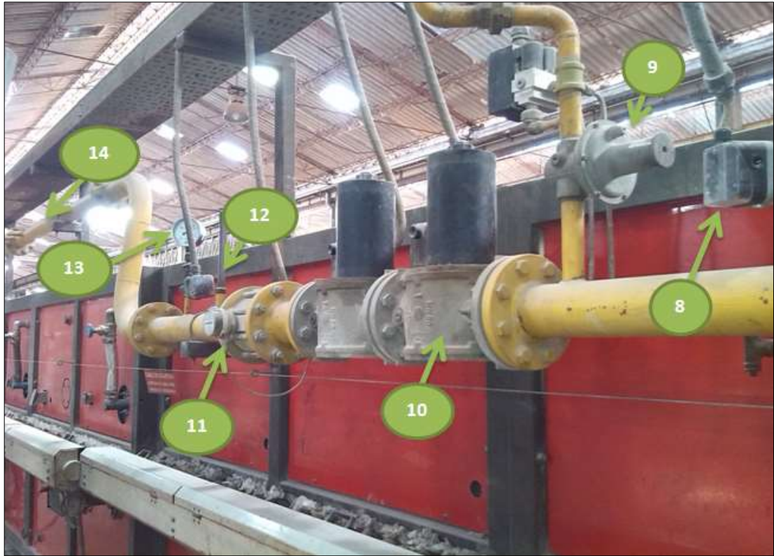
Fotografía 3. Grupo de regulación y control de gas.
