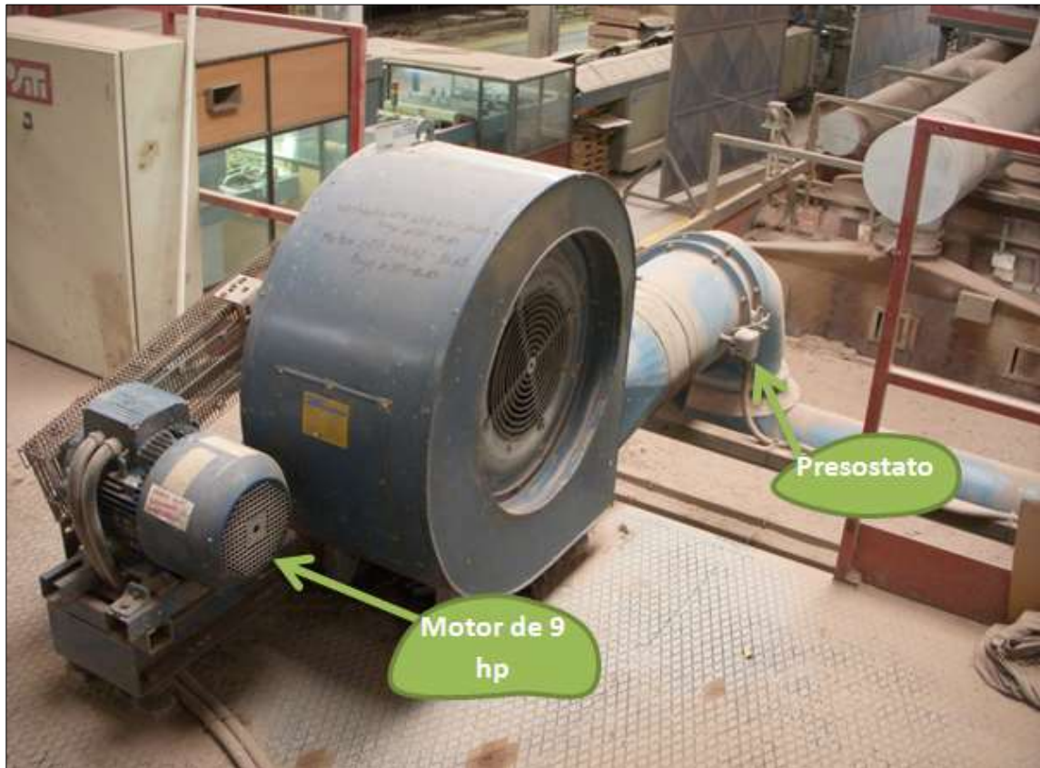
Fotografía 12. Ventilador enfriamiento contracorriente.
