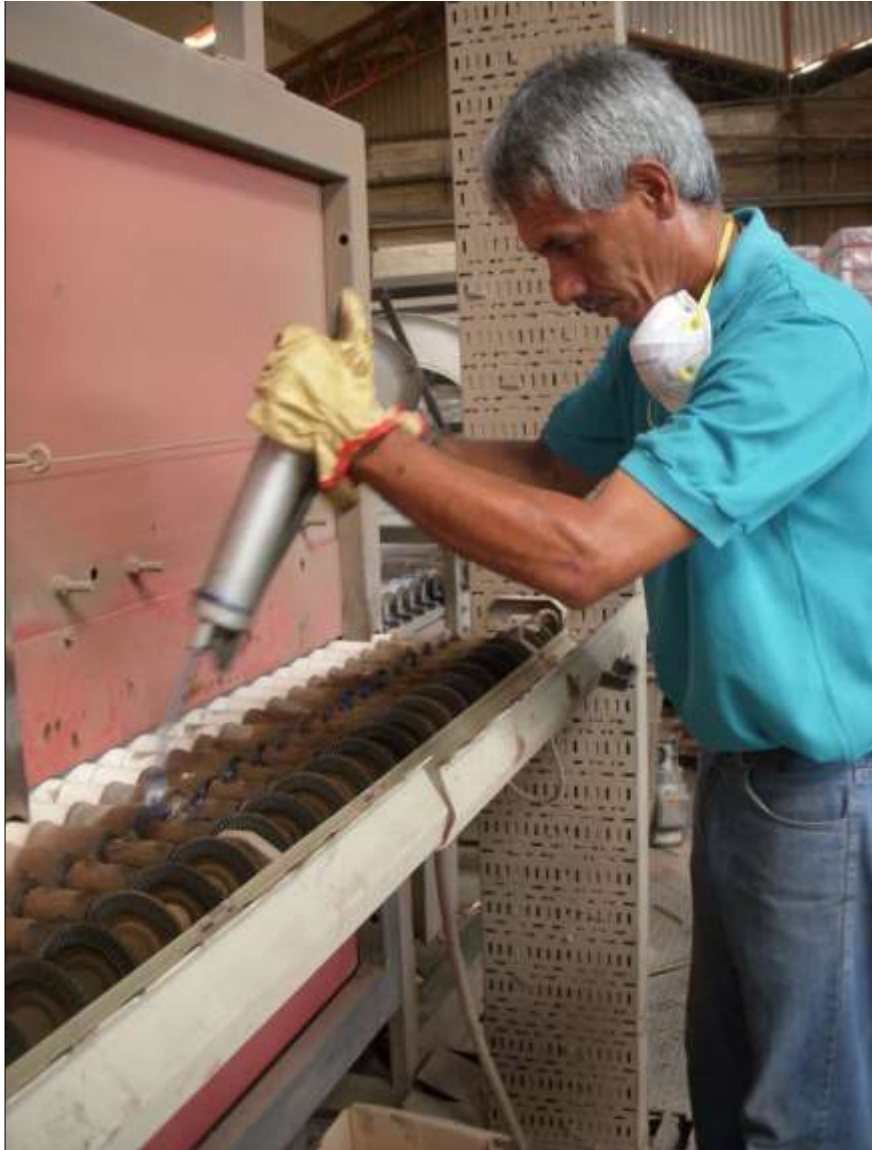
Fotografía 33. Lubricación de los rodamientos de los casquillos de arrastre de los rodillos.
