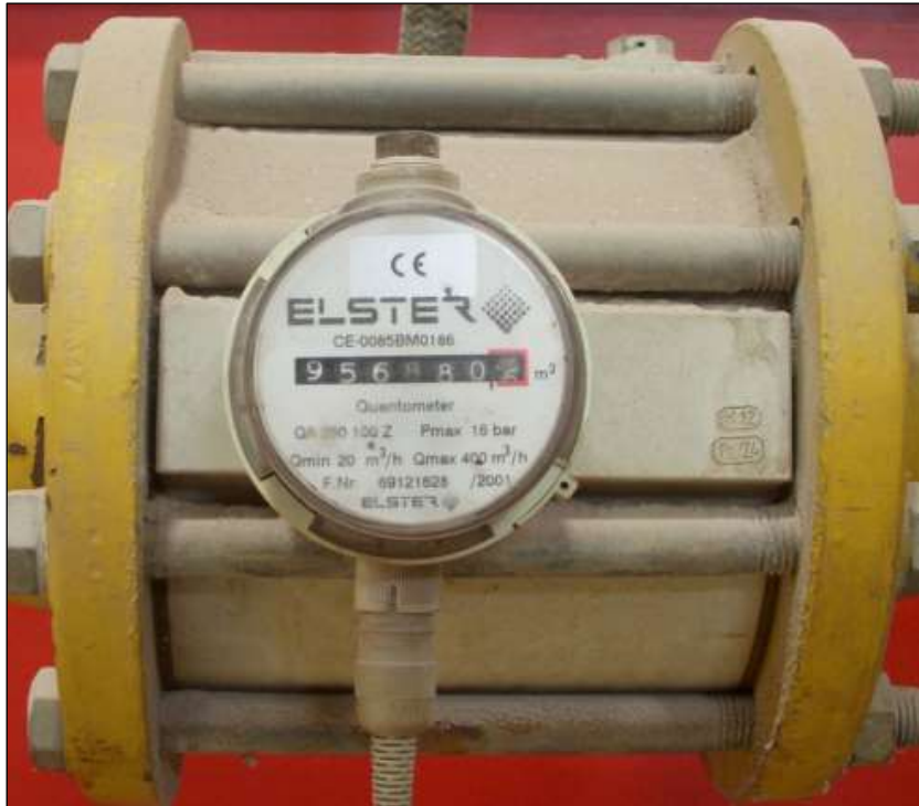
Fotografía 35. Medidor del flujo de gas.
