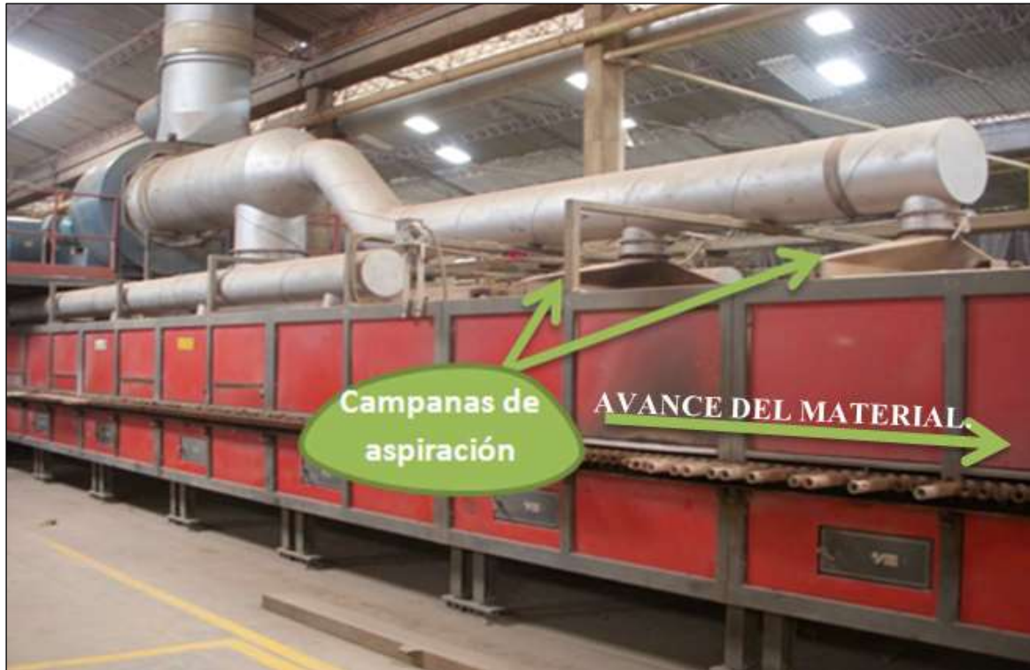
Fotografía 25. Zona de enfriamiento indirecto.
