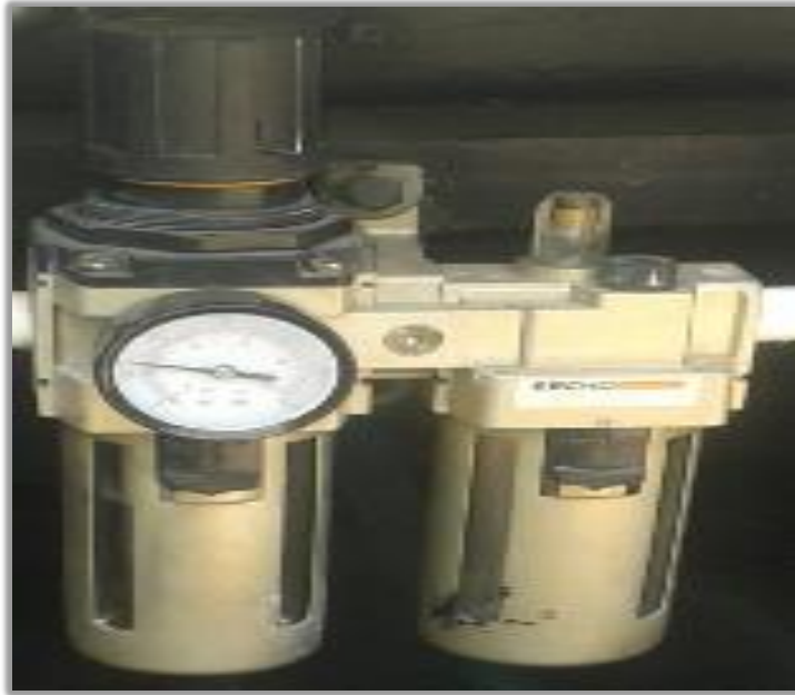
Imagen 6 . Filtros separadores y lubricadores para las bombas neumáticas.
