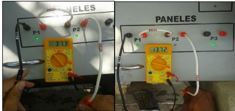
Figura 64. Toma de tensión y corriente en paneles (1 y 2) en serie.
