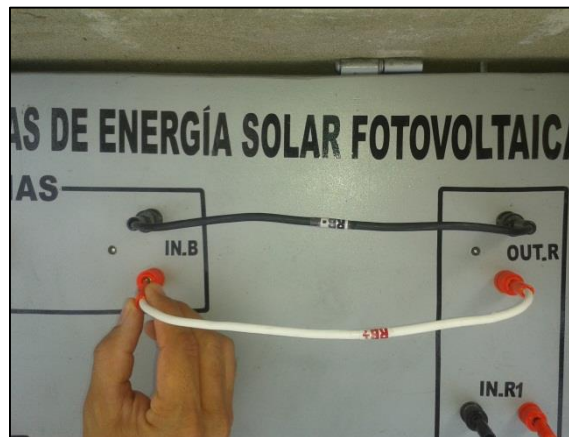
Figura 53. Conexión de regulador a baterías.
