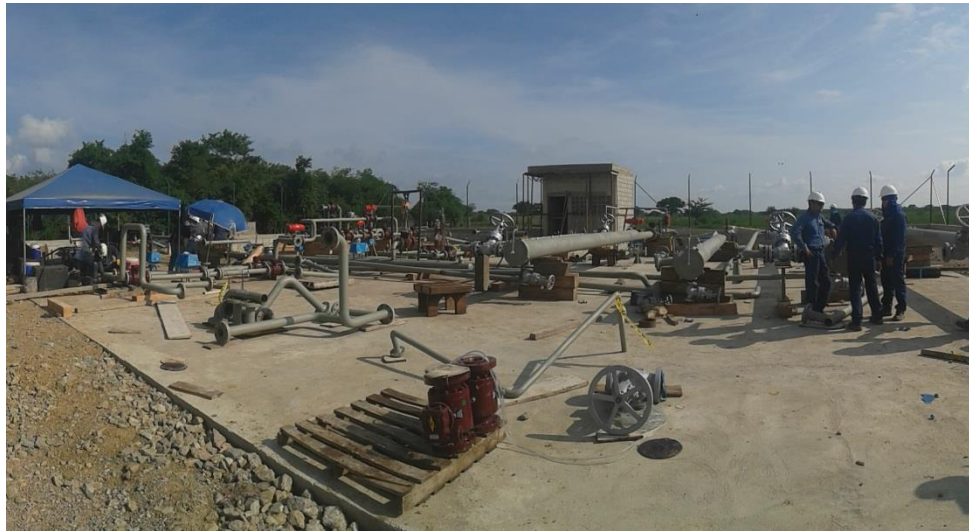
Foto 17. Armado de estación de regulación y medición.(ERM)
