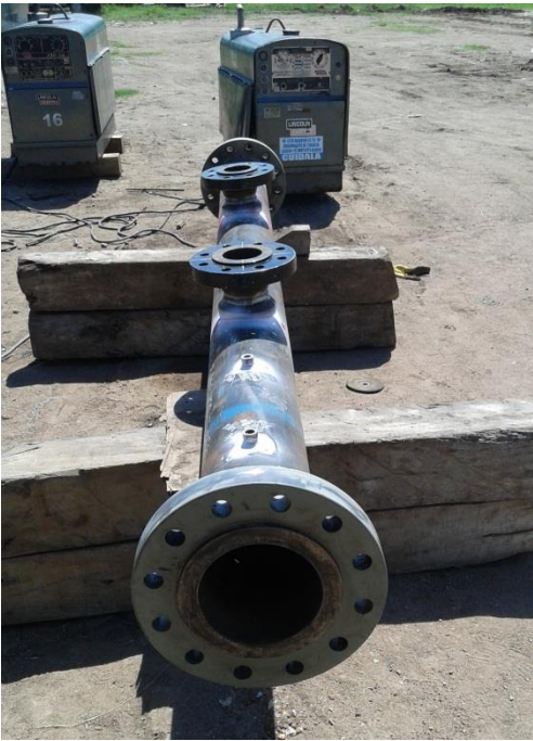
Foto 20. Prefabricado de válvulas seccionadoras
