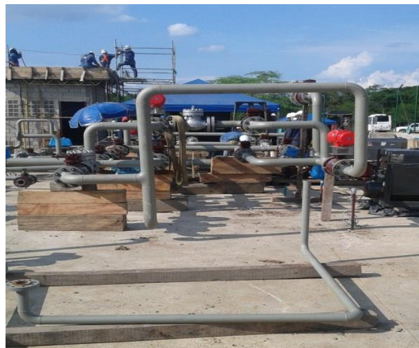
Foto 18. Armado de estación de regulación y medición. (ERM)
