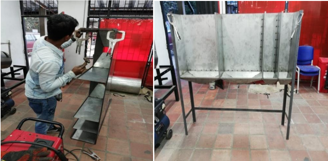
Figura 22. Estructura de tolvas de almacenamiento.
