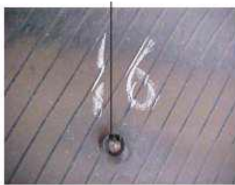
Figura 15. Daño pasante en banda de rodado
