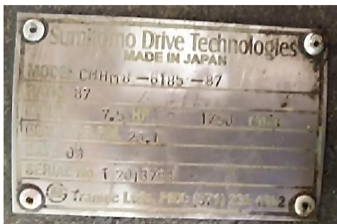
Fotografía 1: Placa del motor reductor de REDLER 1
