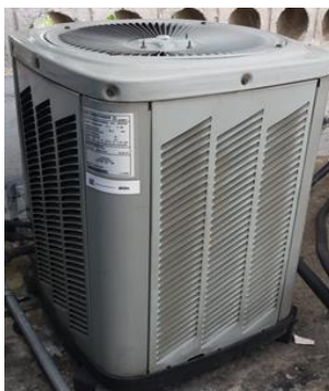
Figura 14. Unidad condensadora de descarga vertical Fuente (Elaboración propia, 2018)
