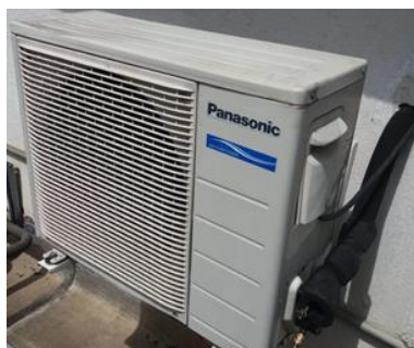
Figura 15. Unidad condensadora de descarga horizontal Fuente (Elaboración propia, 2018)
