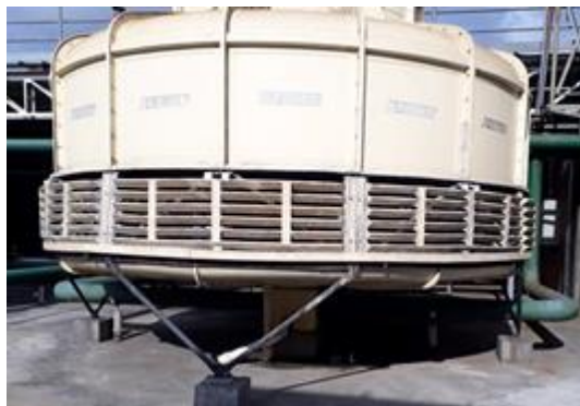
Figura 6. Condensador de agua (torre de enfriamiento)
