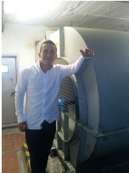
Figura 71. Pasante dentro del cuarto de una UMA
