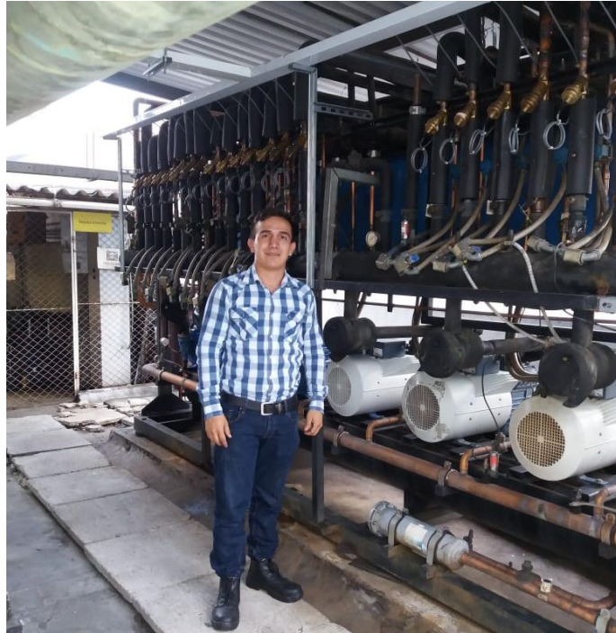
Figura 68. Pasante frente al rack de compresores semi herméticos
