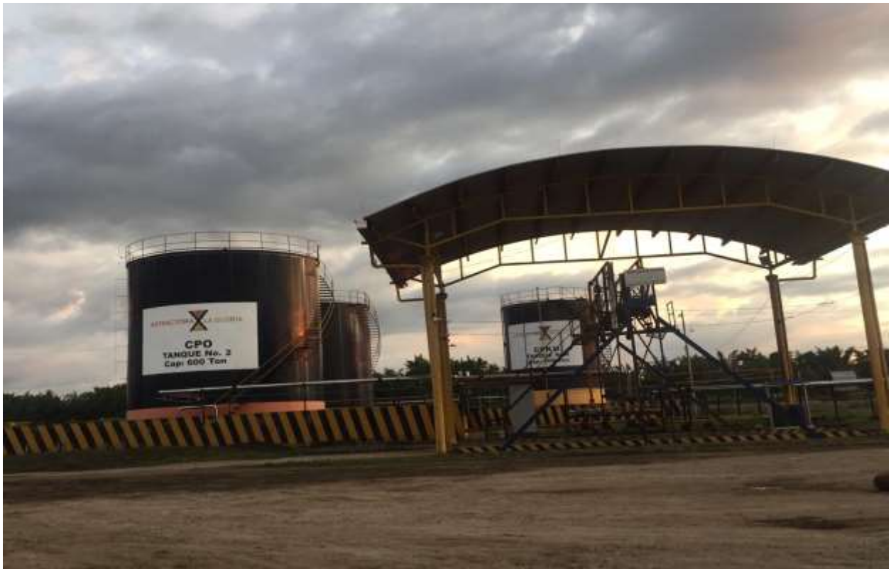
Tanques de almacenamiento Fuente Pasante
