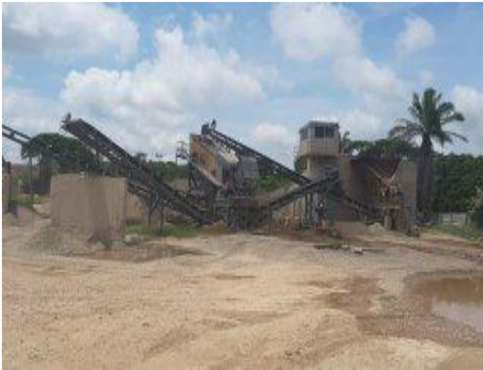
Figura 2. Planta de trituración de la empresa SLM CONSTRUCCIÓN S.A
