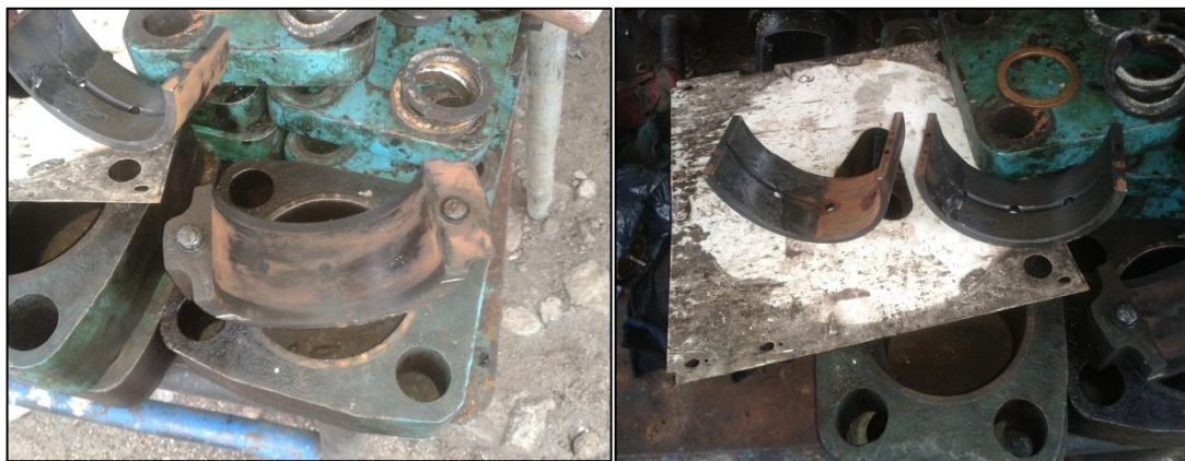
Imagen 6. Ruptura de pernos y desgaste de los casquetes de la bomba Triko.
