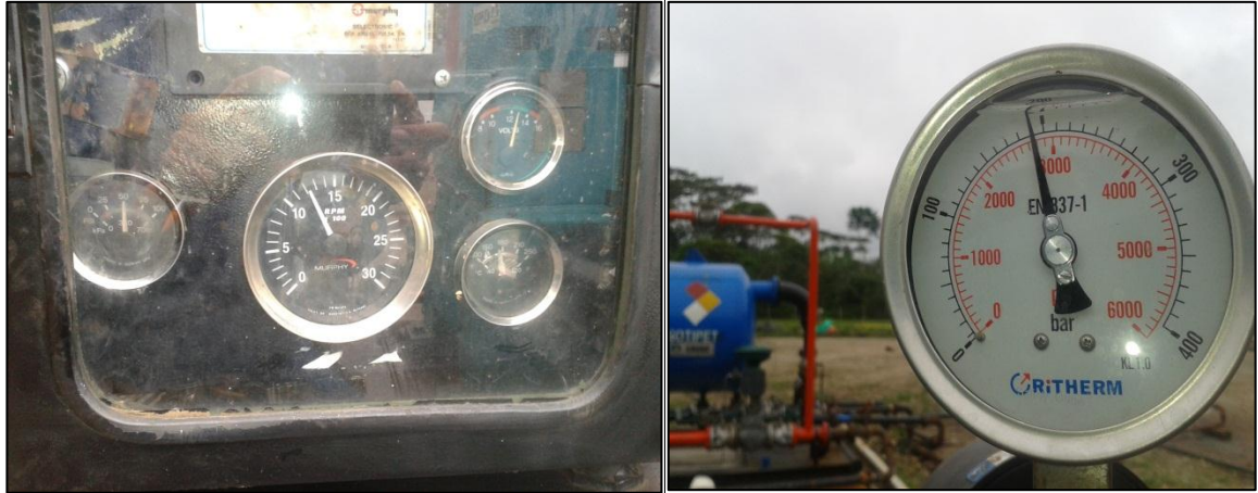
Imagen 5. Condiciones de trabajo de la bomba triplex (1200 rpm-2800psi presión de inyección) en el lugar de producción.
