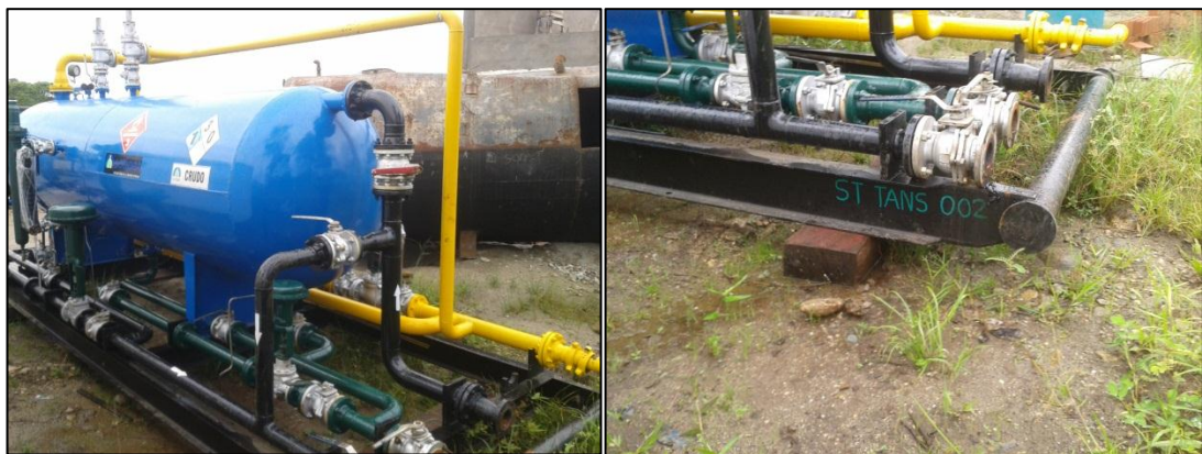
Imagen 2. Marcación del Separador Trifásico ST TANS 002.
