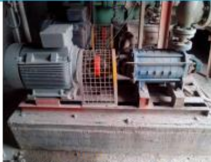
Cuarto de Bombas Sulzer
