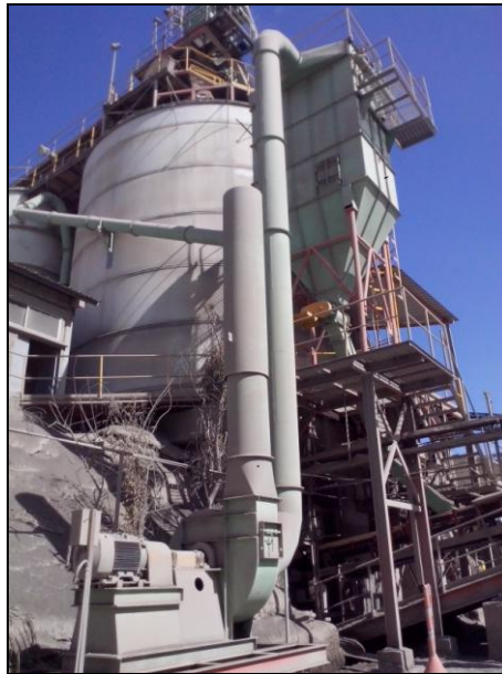
Foto 2. Filtro de mangas del área de aditivos de la planta Los Patios
