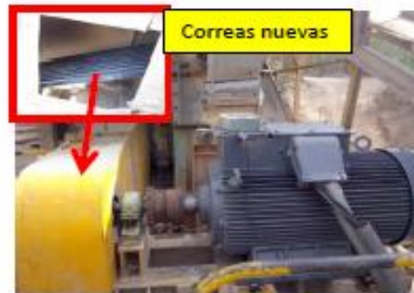
Mantenimiento a motor y cambio de correas
