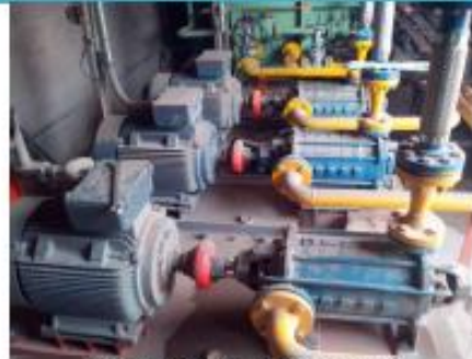
Cuarto de Bombas Sulzer
