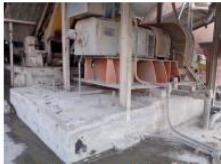
Base de motor, posición antigua (lado norte)
