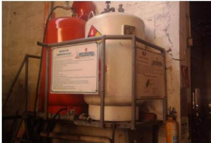
Figura 8. Tanques estacionarios de GLP.
