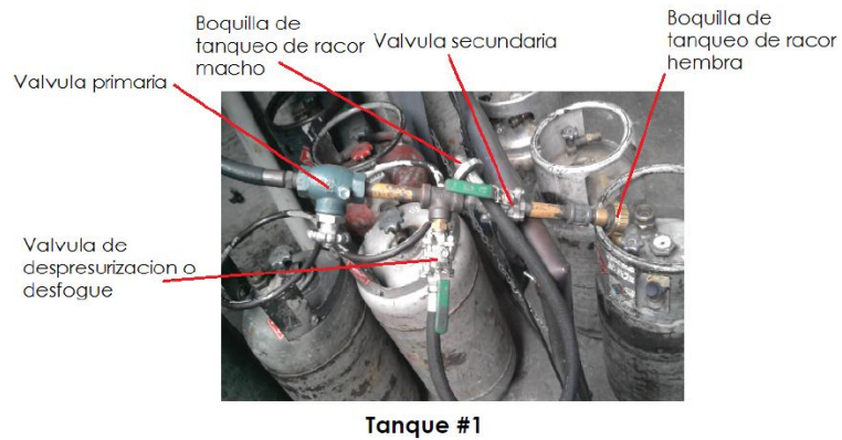
Figura 10. Mangueras de tanqueo de pipetas de montacargas
