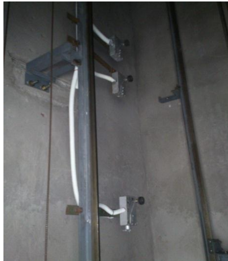
Fotografia 20. Sensores de parada de cabina (finales de carrera).
