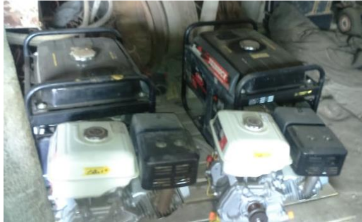
Figura 7. Fotografía el lugar donde se encuentran los motores. Fuente. Autor de la pasantía, 2020
