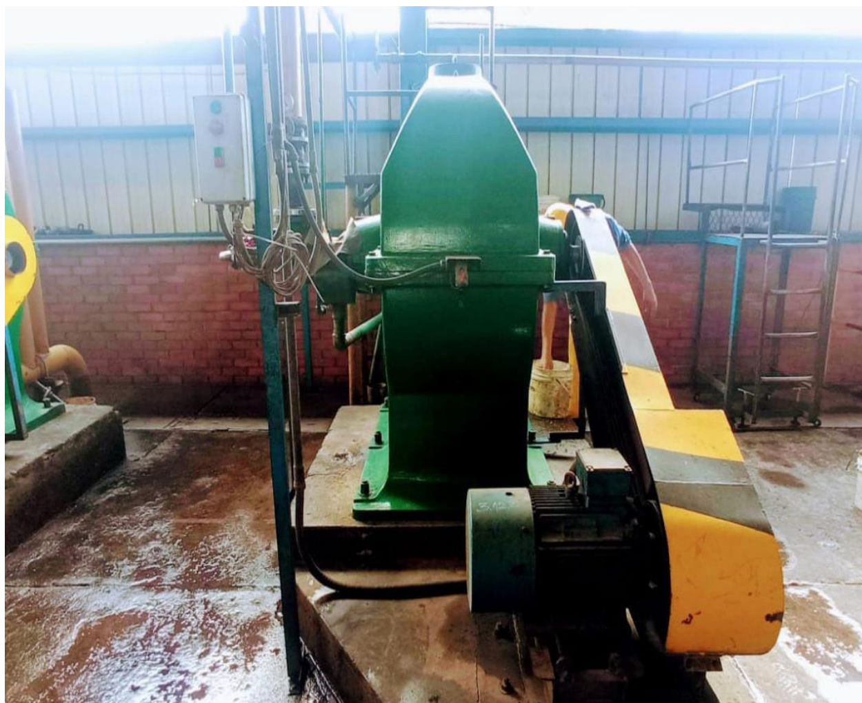
Centrifuga de Lodos
