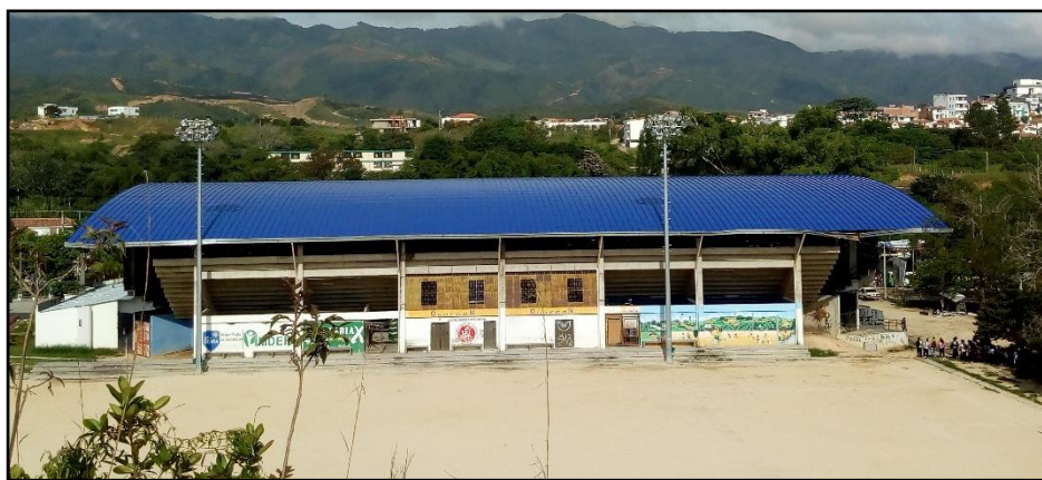
Figura 18. Adecuación de cubierta coliseo Argelino Duran Quintero. Fuente: Autor de la pasantía.
