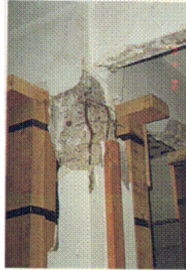
Fotografía 1. Falla en columna. Fuente: Helene P. Pereira F. (2003)
