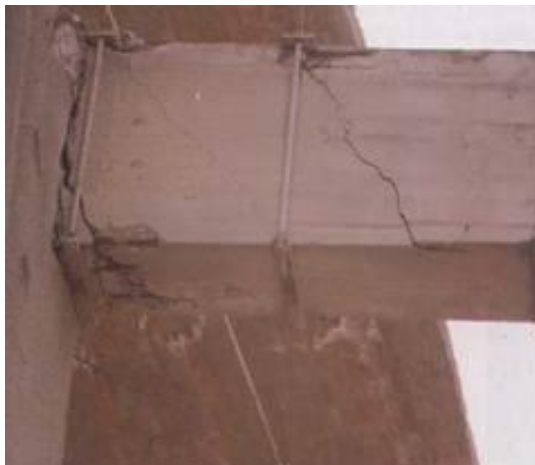
Fotografía 2. Falla a flexión en viga.
