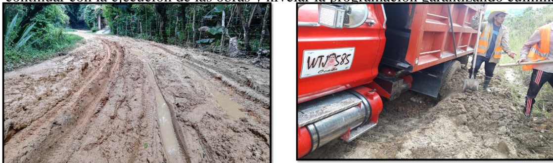
Figura 20. Estado de la vía por la ola invernal que ha generado el atraso en la ejecución de las obras. Fuente: Interventoría.
