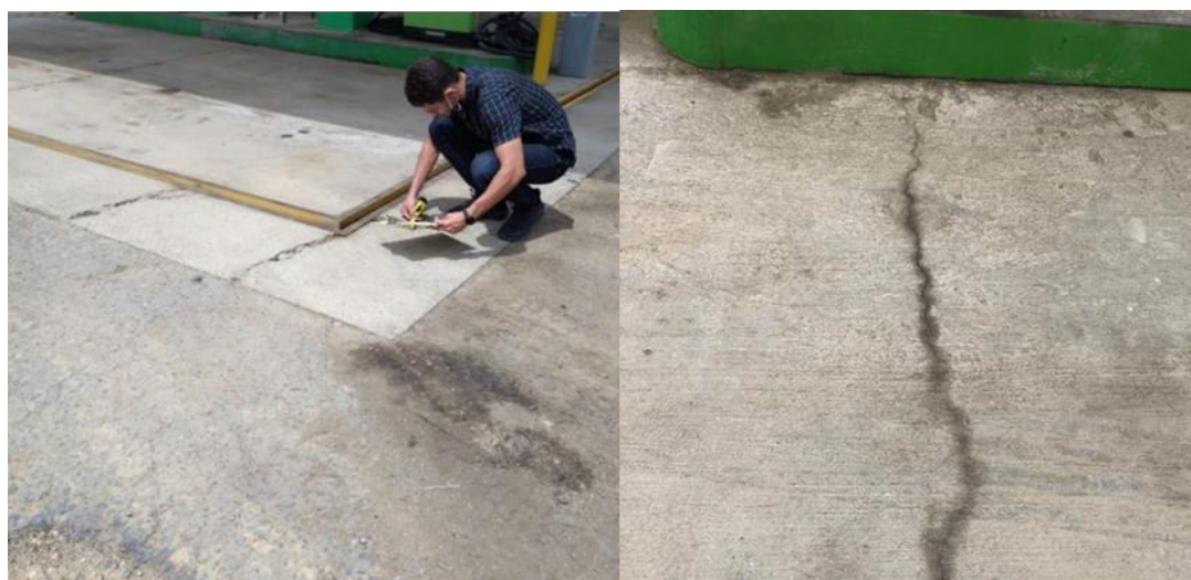
Figura 55. Grietas en la losa de concreto. Fuente. Autores del proyecto.
