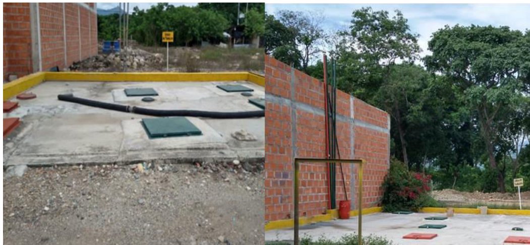
Figura 63. Zona de tanques. Fuente. Autores del proyecto.
