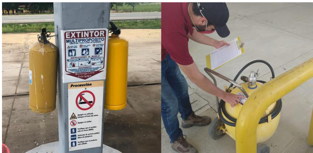
Figura 41. Dotación contraincendios. Fuente. Autores del proyecto.
