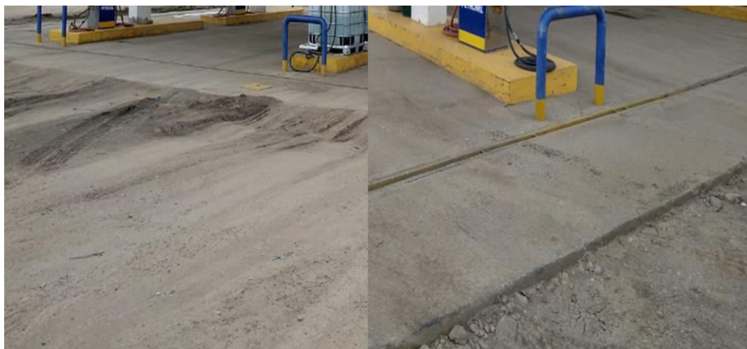
Figura 64. Falla en la subrasante. Fuente. Autores del proyecto.
