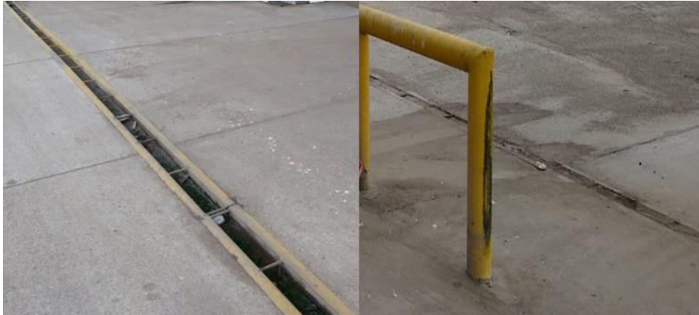
Figura 57. Rejillas perimetrales. Fuente. Autores del proyecto.
