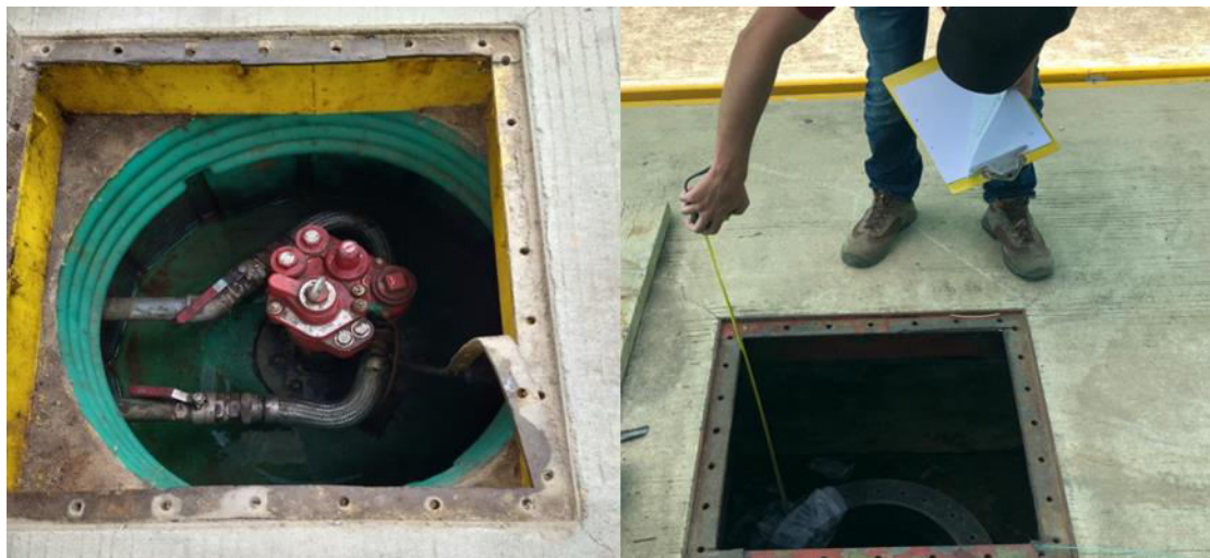
Figura 47. Manholes de acceso y succión. Fuente. Autores del proyecto.
