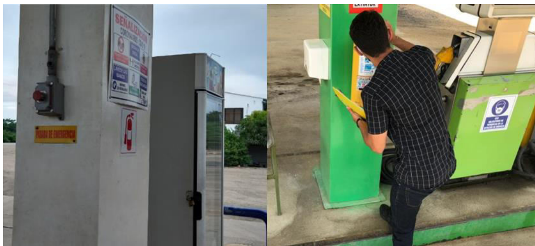
Figura 61. Dotación contraincendios. Fuente. Autores del proyecto.
