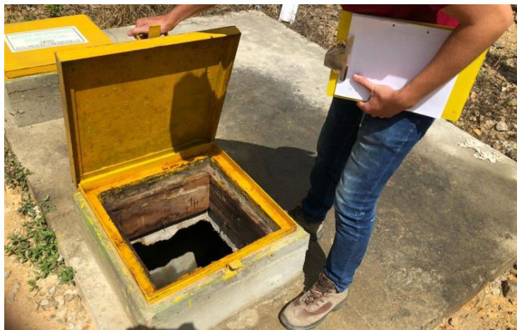
Figura 45. Inspección trampa de grasas. Fuente. Autores del proyecto.
