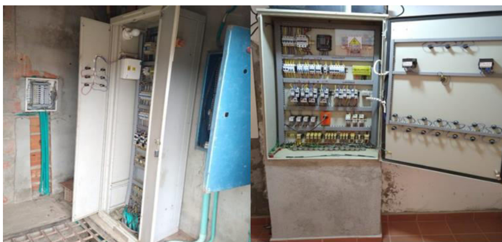
Figura 62. Gabinetes eléctricos. Fuente. Autores del proyecto.
