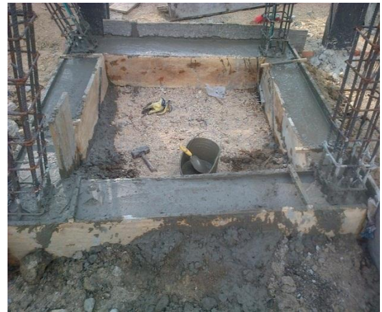
Fotografía 34. Viga de amarre de la taquilla de la oficina de la plaza
