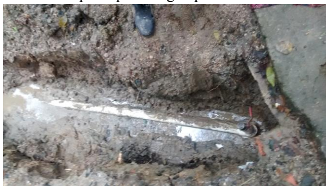
Foto 23. Tubo principal de agua potable de 2" afectado.
