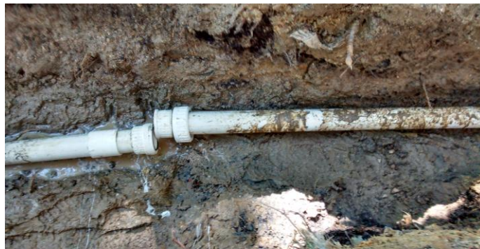
Fotografía 27. Conexión de tubería con Unión universal de 2”
