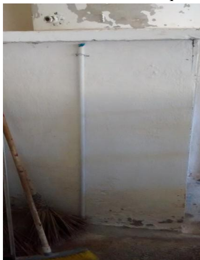
Foto 1. Tubo de PVC al tanque aéreo.
