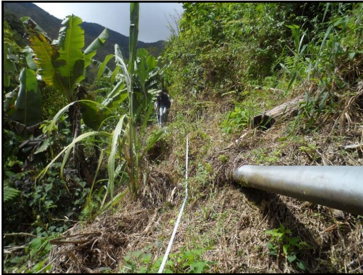
Foto No 3 Línea de aducción actual captación - desarenador.
