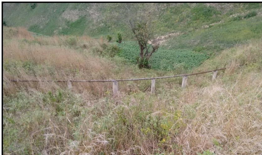
Foto No 6 Tubería de aducción desarenador – tanque de almacenamiento existente.
