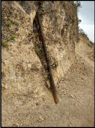
Foto No 12 Corrosión tubería de hierro
