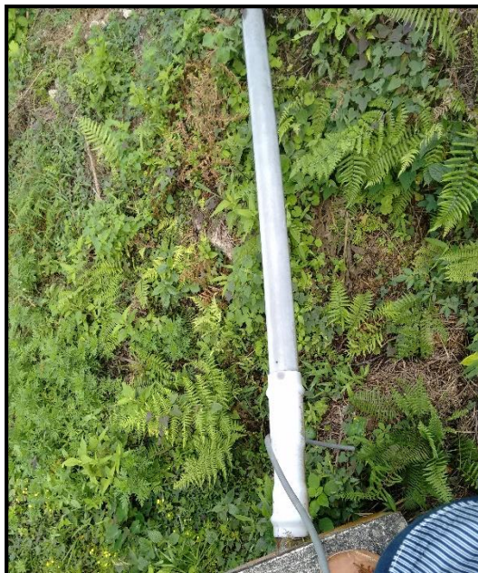
Foto No 4 Línea de aducción llegada al desarenador.
