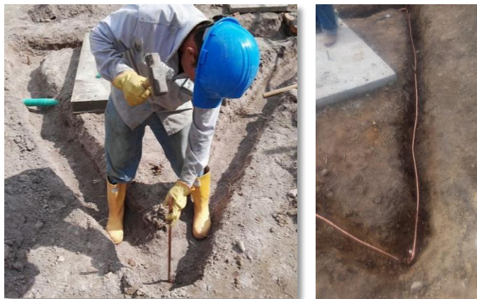
Fotografía 3. Sistema polo a tierra Fuente. Pasante
