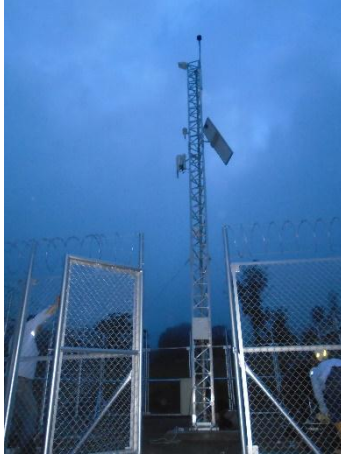
Fotografía 7. Torre de 9m de altura. Fuente. Pasante
