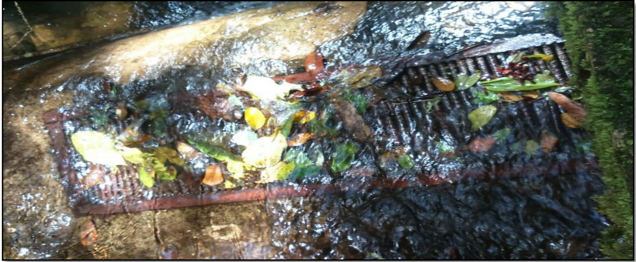
Figura 25. Rejilla de fondo, captación Quebrada La Maravilla. Fuente: Autores del proyecto.
