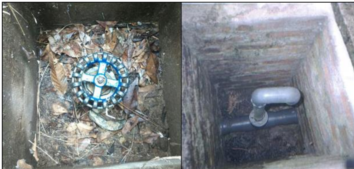
Figura 36. Válvula purga y válvula ventosa de la aducción Desarenador-Planta. Fuente: Autores del proyecto.
