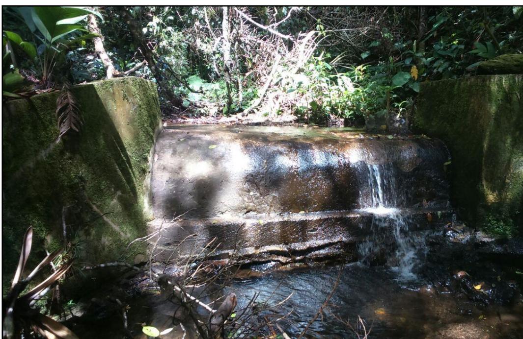
Figura 24. Captación existente, Quebrada la Maravilla. Fuente: Autores del proyecto.
