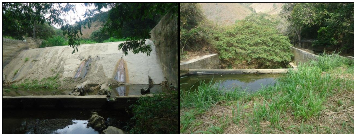
Figura 8. Captación del rio Rio de Oro, ubicada en el corregimiento El Gitano.
