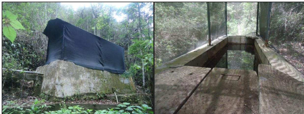
Figura 14. Desarenador de la captación de la Quebrada La Toma
