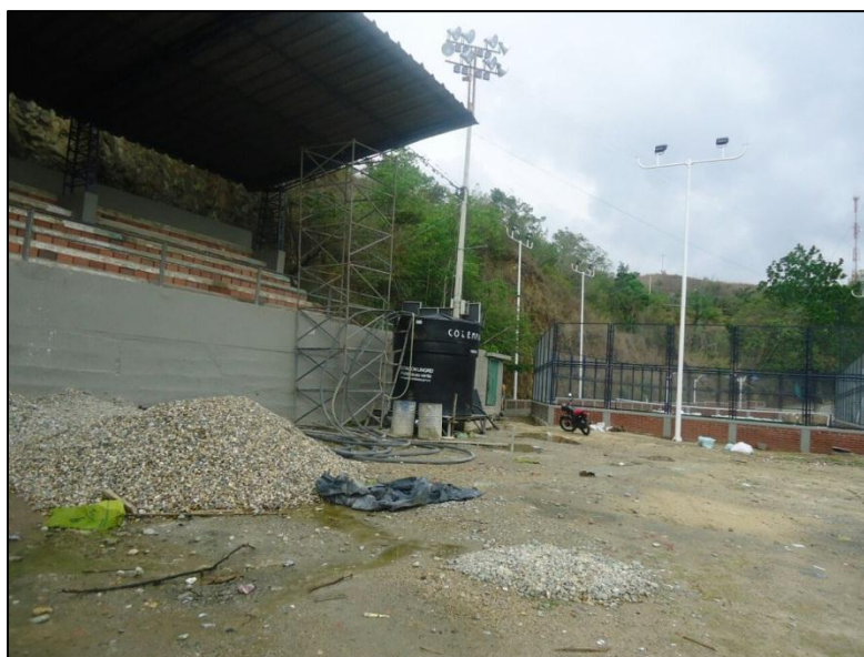
Figura 12. Tanque de almacenamiento de agua extraída desde los pozos subterráneos
