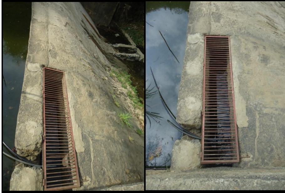
Figura 9. Rejilla de fondo en la Captación del rio Rio de Oro
