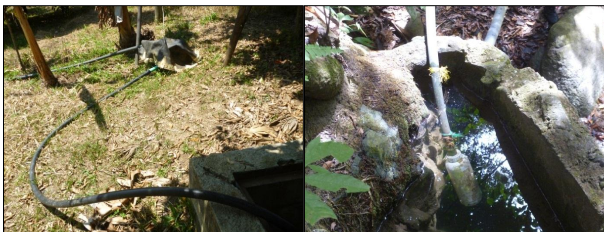
Figura 16. Conexiones ilegales en el sistema de conducción del rio Rio de Oro
