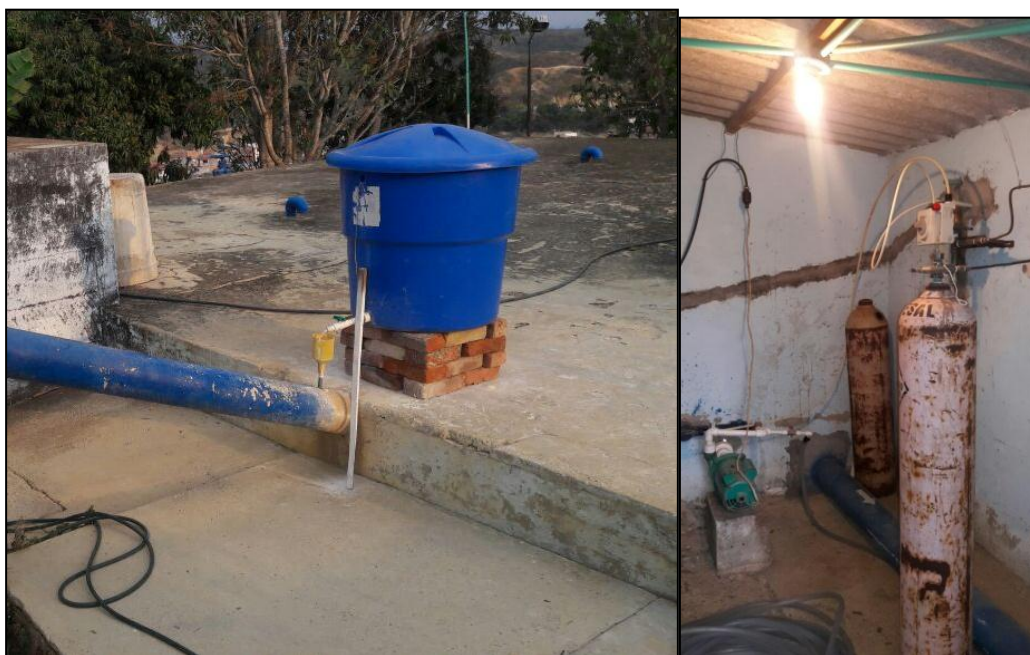
Figura 24. Equipos de cloración
