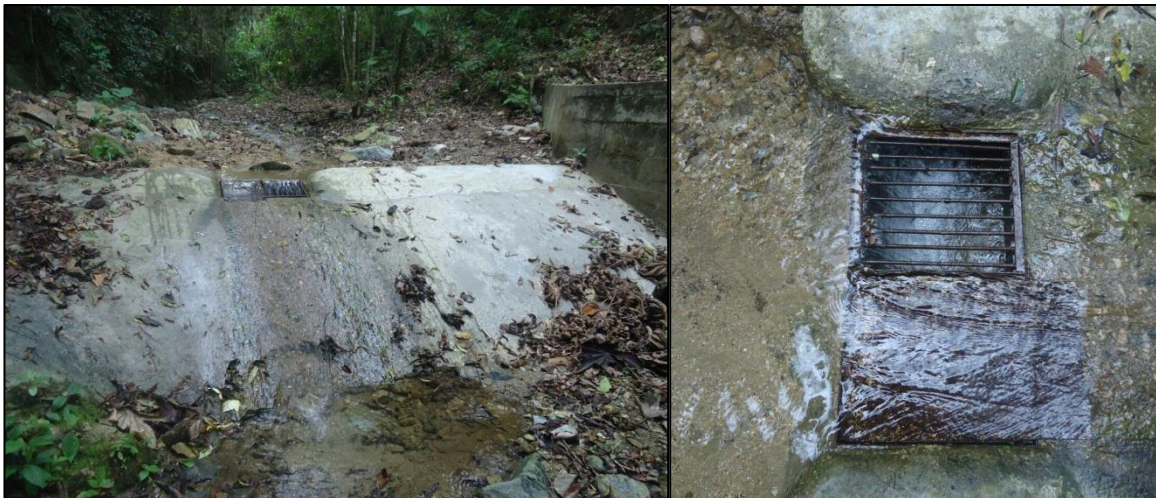
Figura 10. Captación Quebrada La Toma y rejilla de fondo, respectivamente
