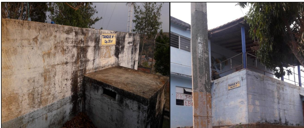
Figura 28. Tanques de almacenamiento N°1 y N°2
