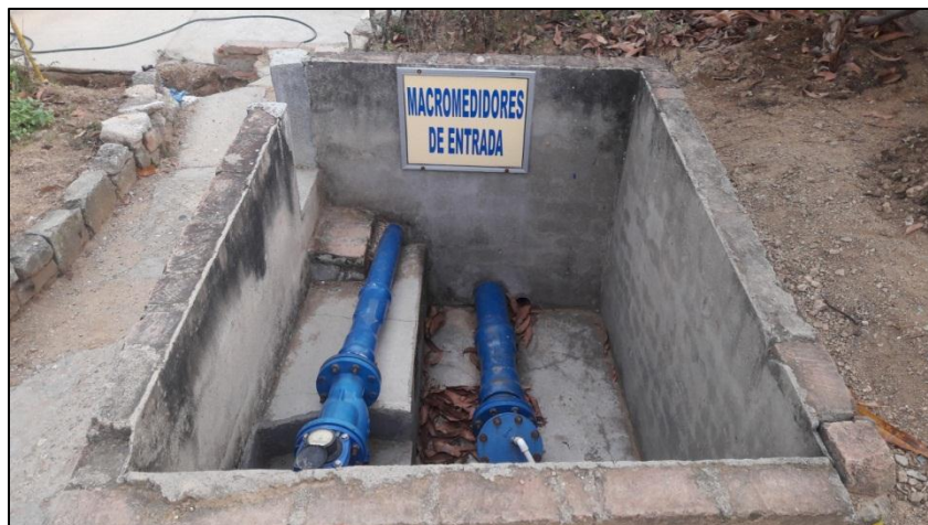
Figura 30. Macromedidores de entrada
