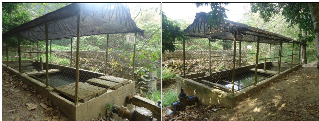
Figura 13. Desarenador de la captación del rio Rio de Oro
