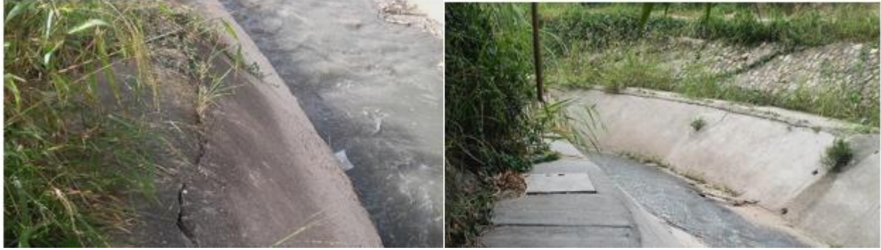
Figura 15. Canal con grietas y fisuras
