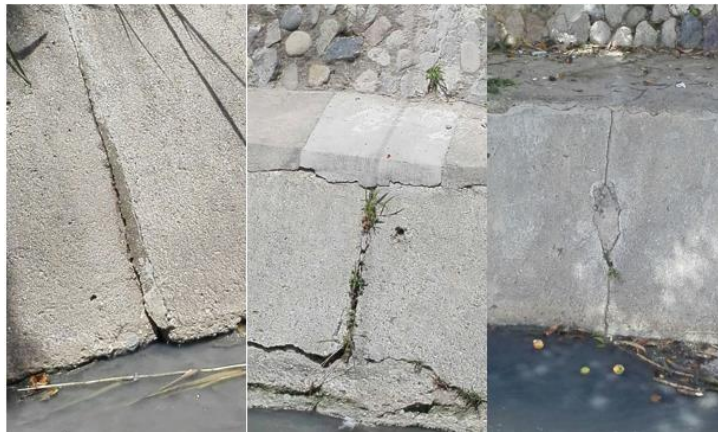
Figura 18. Canal con desplazamiento de juntas
