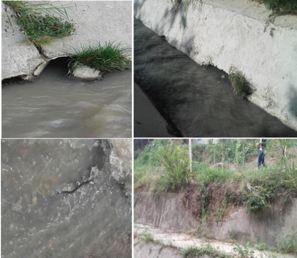
Figura 11. Erosión en el canal
