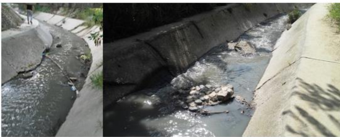
Figura 14. Canal con escombros
