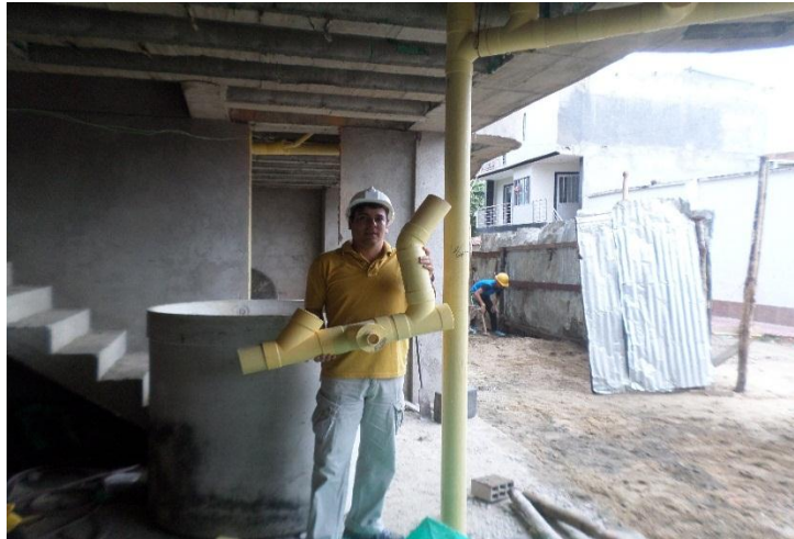
Fotografía 9. Red hidráulica y sanitaria.
