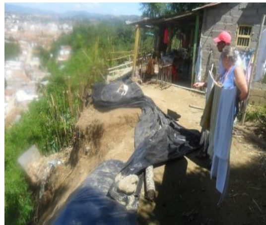
Foto 67. Deslizamiento Activo Tipo Traslacional - Caído KDX 53
