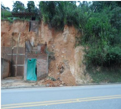
Foto 94. Deslizamiento Activo Tipo Caído
