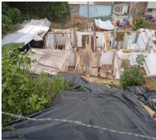
Foto 66. Deslizamiento Activo Tipo Traslacional CLL 11A 01-02
