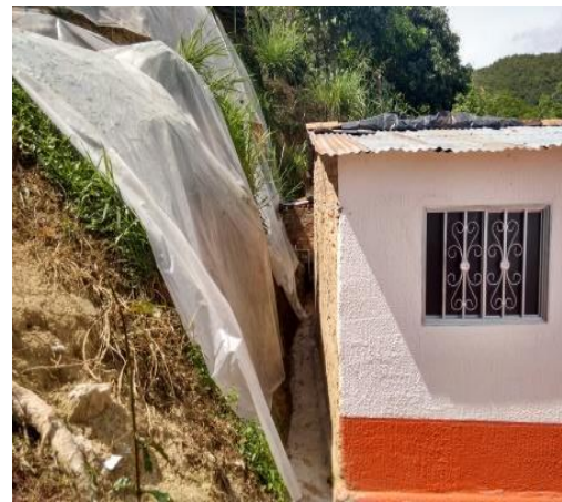
Foto 87. Deslizamiento Inactivo Tipo Propenso Traslacional – Rotacional – Caído KDX 247-400
