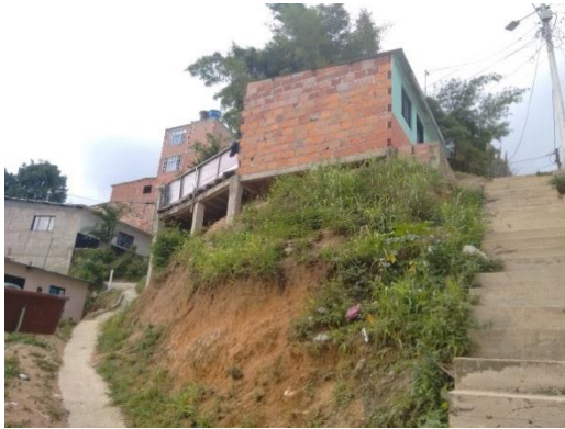
Foto 96. Deslizamiento Inactivo Tipo Propenso Caído. KDX 446-320
