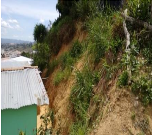
Foto 84. Deslizamiento Activo Tipo Traslacional KDX 239-140
