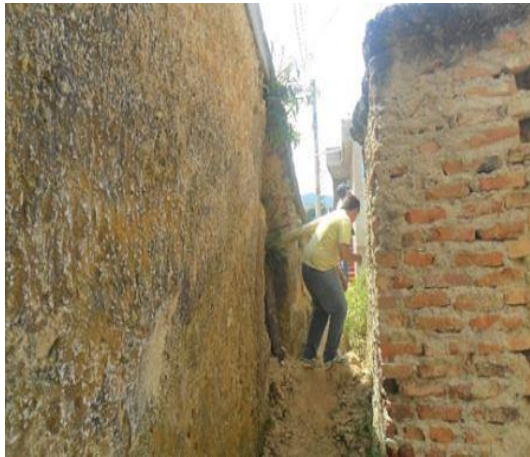
Foto 28. Deslizamiento Inactivo Tipo Propenso Caído CALLE 2 # 23-9
