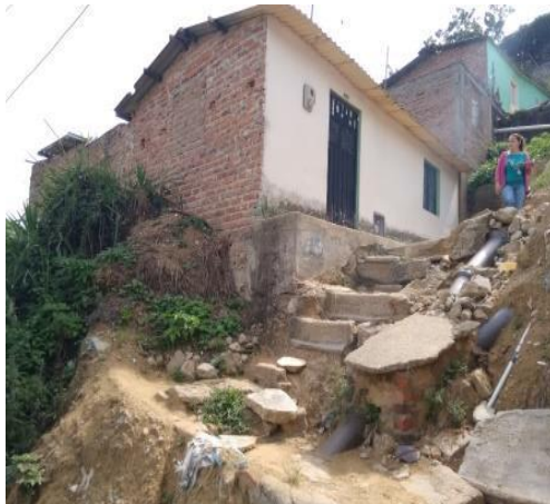
Foto 86. Deslizamiento Inactivo Tipo Propenso Caído KDX 239-120
