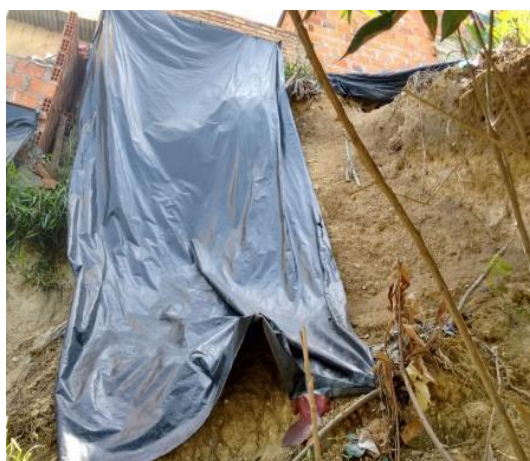
Foto 79. Deslizamiento Activo Tipo Caído KDX407-530
