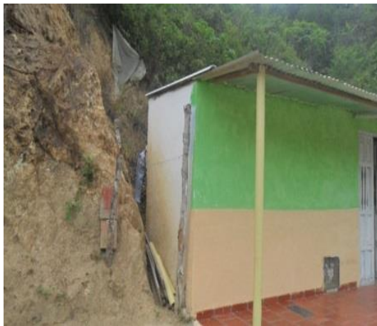
Foto 46. Deslizamiento Activo y Propenso Tipo Caído KDX 106-120
