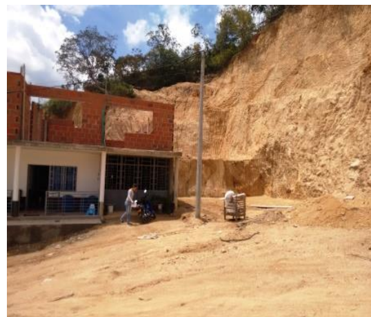
Foto 43. Deslizamiento Inactivo Tipo Propenso Caído KDX 333-590
