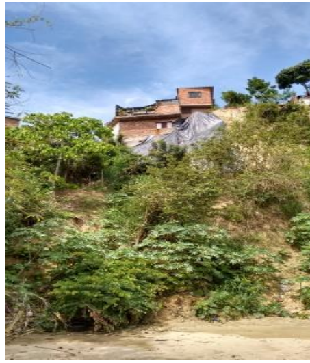
Foto 39. Deslizamiento Activo Tipo Traslacional – Caído KDX 214-250
