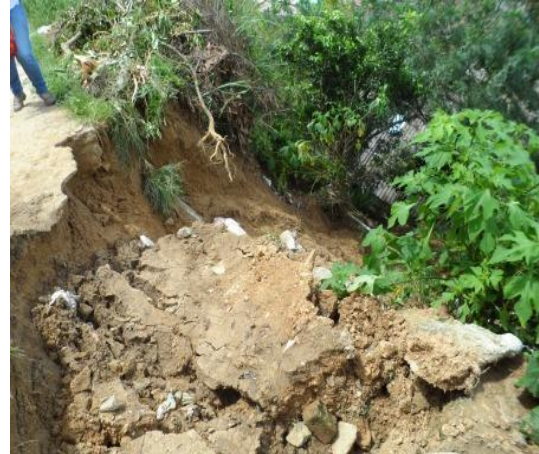
Foto 85. Deslizamiento Activo Tipo Rotacional KDX 242-620
