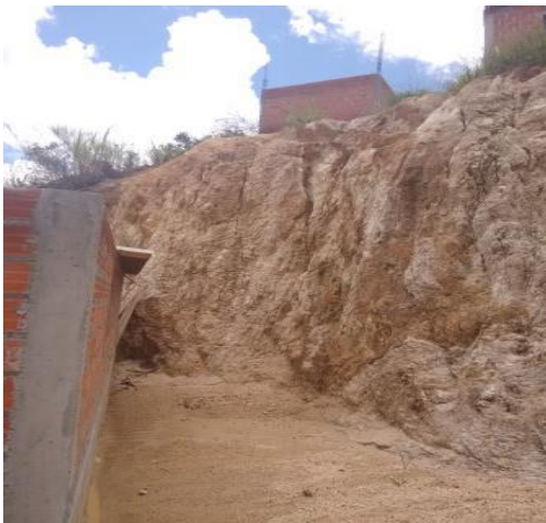
Foto 42. Deslizamiento Activo Tipo Caído KDX 333-591(2)
