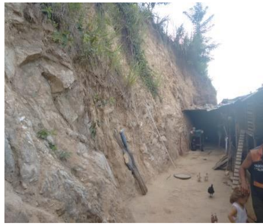
Foto 48. Deslizamiento Activo Tipo Caído KDX 287-850
