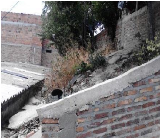
Foto 53. Deslizamiento Inactivo Tipo Propenso Caído CALLE 7A 18-17
