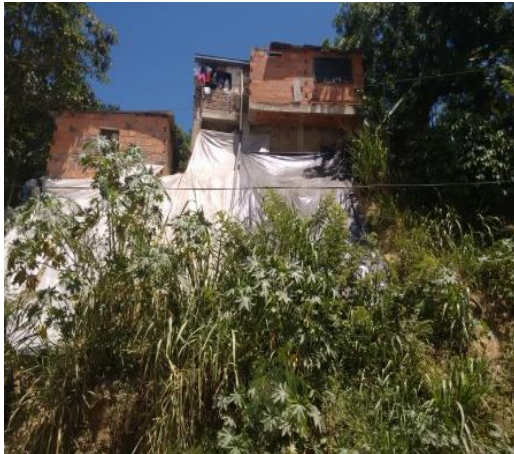
Foto 47. Deslizamiento Activo Tipo Traslacional – Caído KDX 284-680
