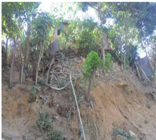
Foto 82. Deslizamiento Activo Tipo Caído
