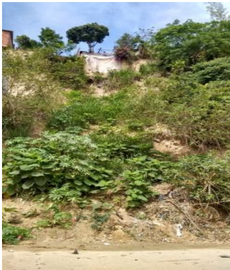
Foto 38. Deslizamiento Activo Tipo Traslacional – Caído KDX 214-230
