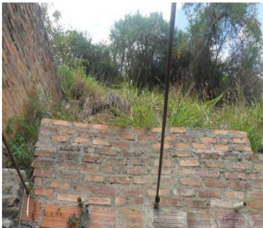
Foto 59. Deslizamiento Inactivo Tipo Propenso Caído CRA 11 N 13-26
