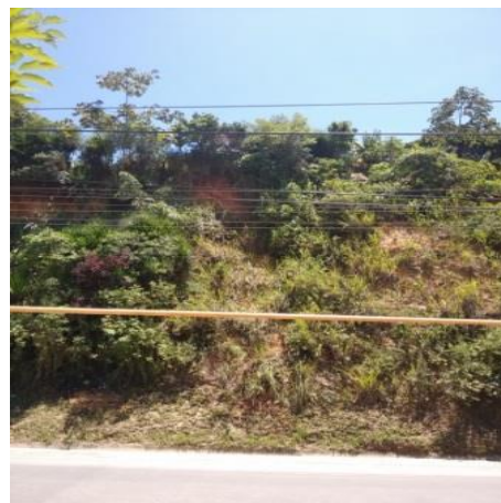
Foto 95. Deslizamiento Activo Tipo Traslacional – Caído
