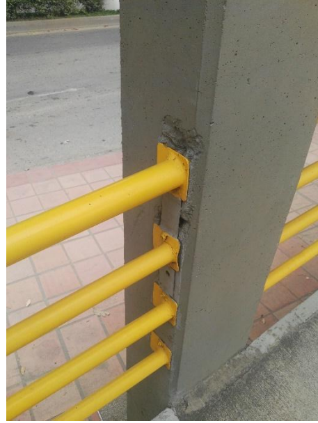
Figura 12. Perdida de concreto en columna por unión baranda. Fuente: Autores del proyecto.
