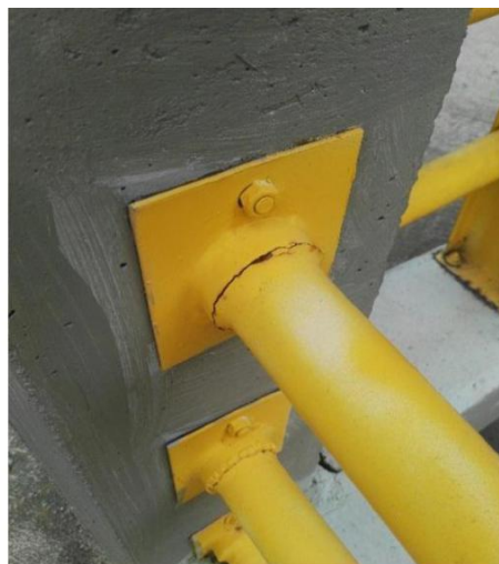
Figura 16. Fisura en soldadura. Fuente: Autores del proyecto.
