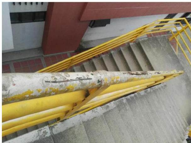
Figura 15. Falta de pintura en las barandas. Fuente: Autores del proyecto.
