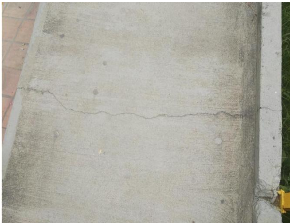
Figura 8. Fisuras acceso en rampa. Fuente: Autores del proyecto.
