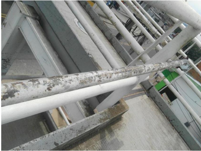
Figura 43. Deterioro de la pintura en pasamanos. Fuente: Autores del proyecto.
