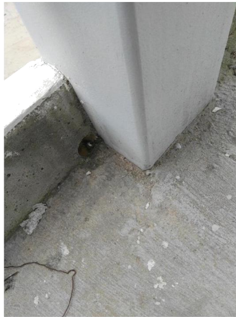
Figura 24. Bajantes con diámetro de 2" Fuente: Autores del proyecto.
