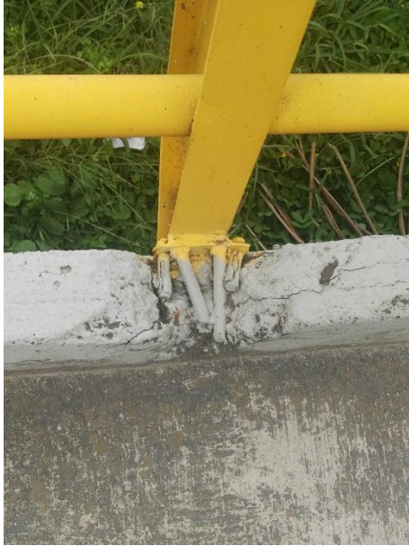
Figura 11. Perdida de concreto bordillo por unión baranda. Fuente: Autores del proyecto.
