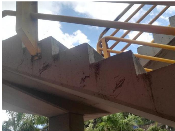
Figura 7. Acero de refuerza visible en escalones. Fuente: Autores del proyecto.
