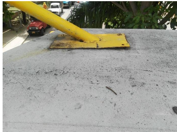
Figura 4. Separación de la protección de cables. Fuente: Autores del proyecto.
