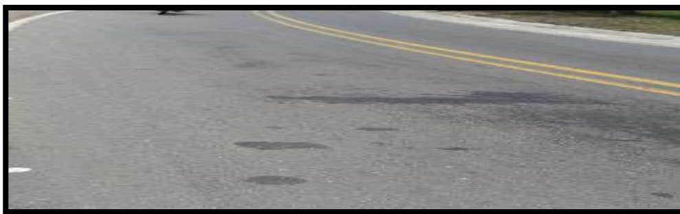
Fotografía 156. Daños que se presentan en zonas puntuales del Hito 60.
