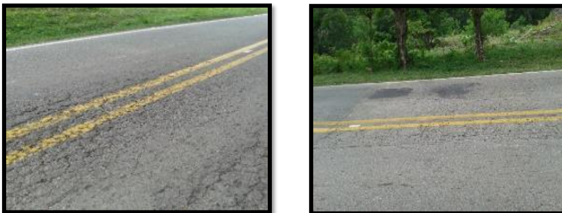
Fotografías 157 y 158. Daños que se presentan en zonas puntuales del Hito 61.
