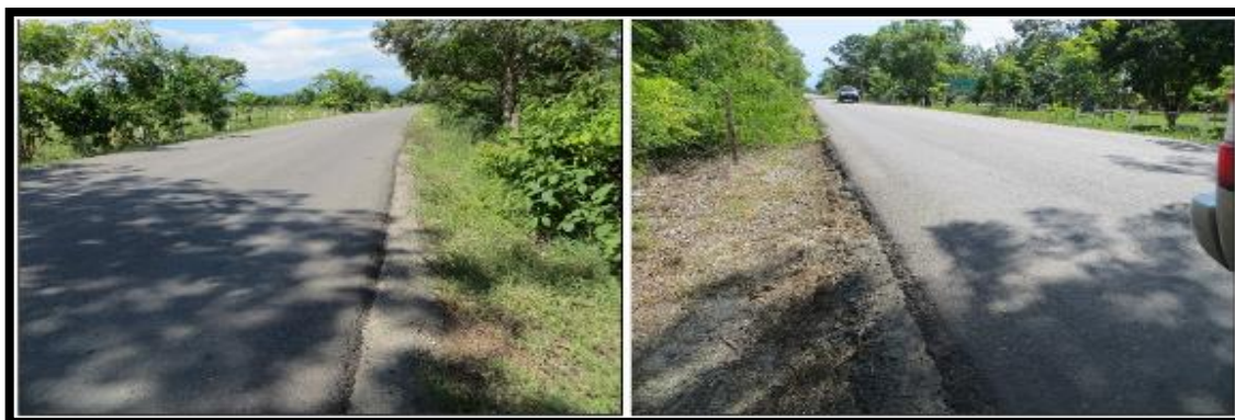
Fotografías 154 y 155. Estado del pavimento Gamarra – Aguaclara.
