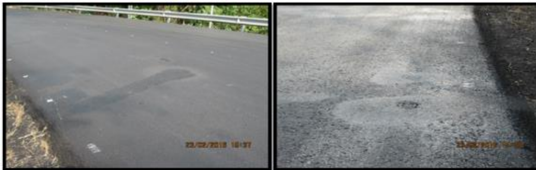
Fotografías 11 y 12. Exudación de pavimento asfáltico PR 14 + 400 al PR 17 + 320.
