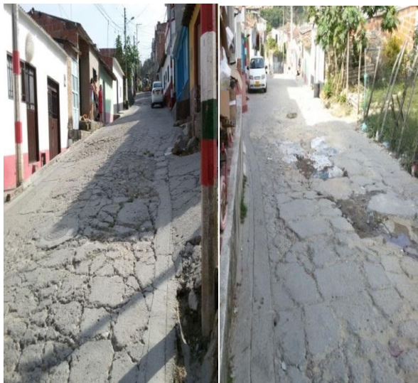
Figura 38. Antes de intervenida, sector Santa Lucia.
