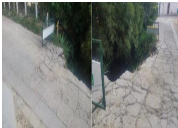
Figura 16, Antes de ser intervenido muro.
