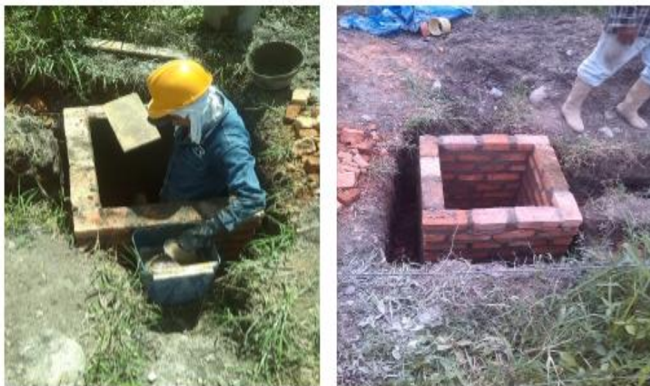
Figura 53. Cajas de Inspección
