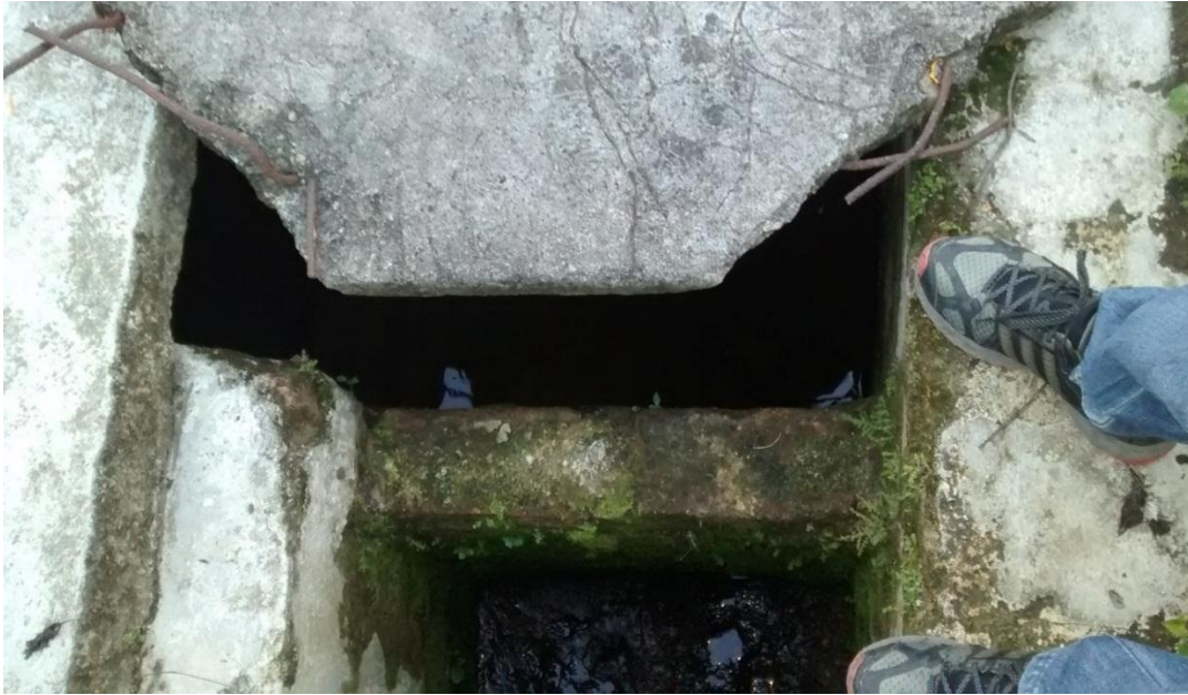
Foto 4. Desarenador sistema de acueducto de Búrbura.
