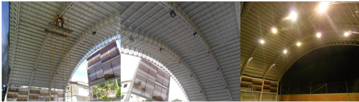
Figura 27. Reflectores instalados, ubicados y encendidos
