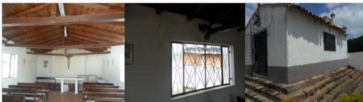
Figura 37. Estado de la capilla antes de su intervención Fuente. Autor del proyecto
