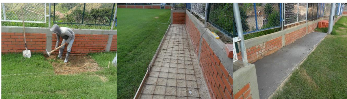
Figura 19. Descapote, armado y vaciado de losa de piso Fuente. Autor del proyecto
