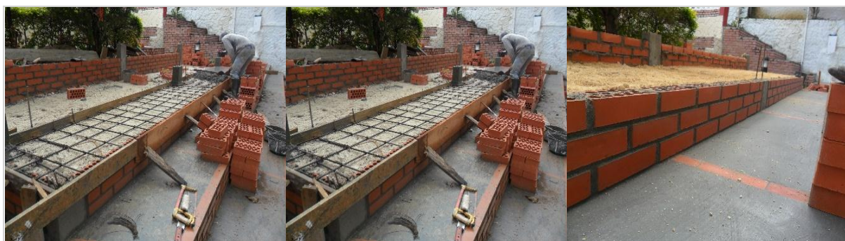
Figura 24. Levante de muro, armado y vaciado de losas para gradería Fuente. Autor del proyecto
