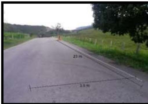
Fotografía 4. Fisura en Medialuna (FML) longitud 23 m y ancho 3.5 m.
