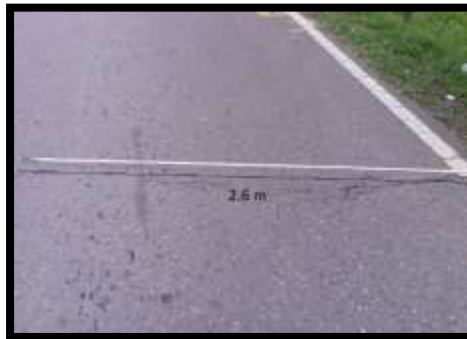
Fotografía 2. Fisura Transversal (FT) longitud 2.6 m.
