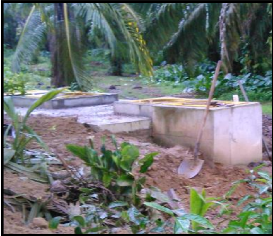
Foto 2. Tanque séptico Casino.
