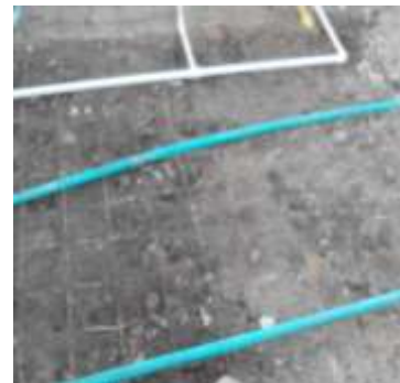
Fotografía 30. Tubería PVC d:1/2" RED 21
