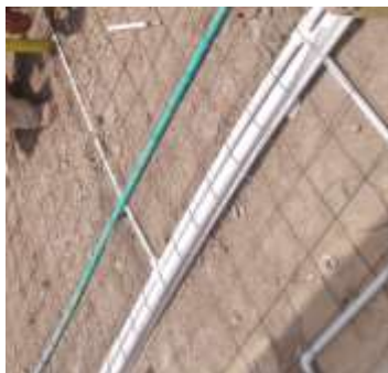
Fotografía 31. Tubería PVC d:3/4" RED 21
