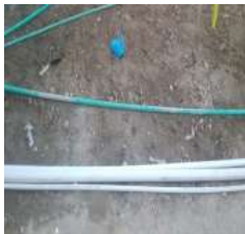
Fotografía 29. Tubería PVC d:1" RED 21
