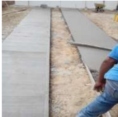
Fotografía 86. Huellas de concreto.
