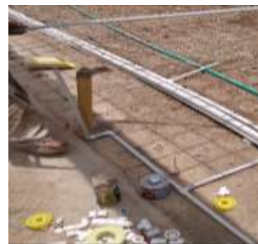
Fotografía 32. Tubería PVC d:1 1/2" RED 21
