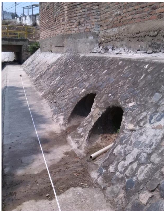
Figura 81. Estructura hidráulica con perforación en T2 en el margen izquierdo.
