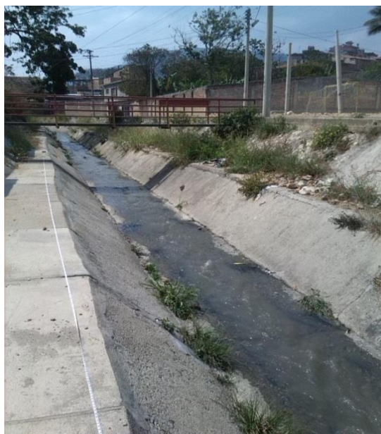
Figura 40. Fractura y asentamiento de la base, vegetación y basuras.
