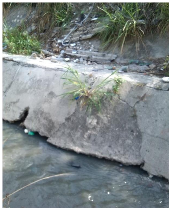
Figura 55. Socavación y desgaste De revestimiento.
