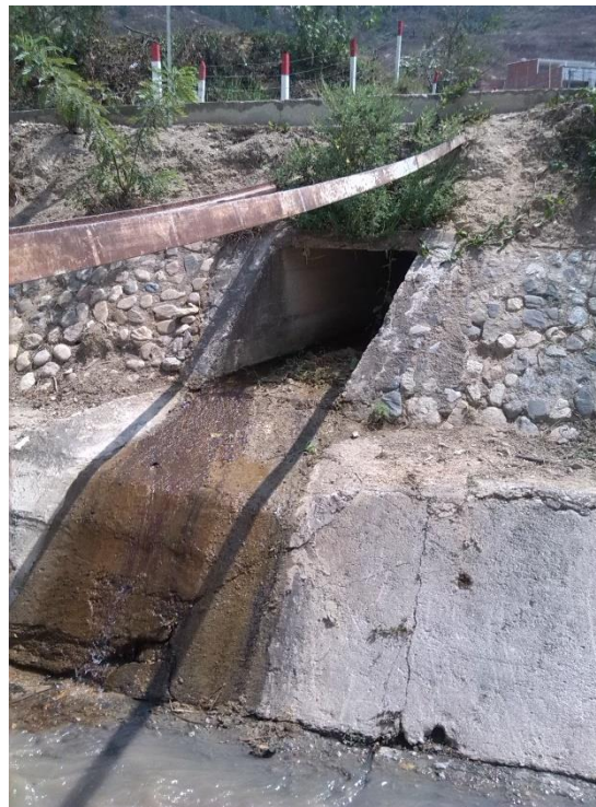
Figura 69. Estructura hidráulica tipo sumidero, agrietamiento y socavación.
