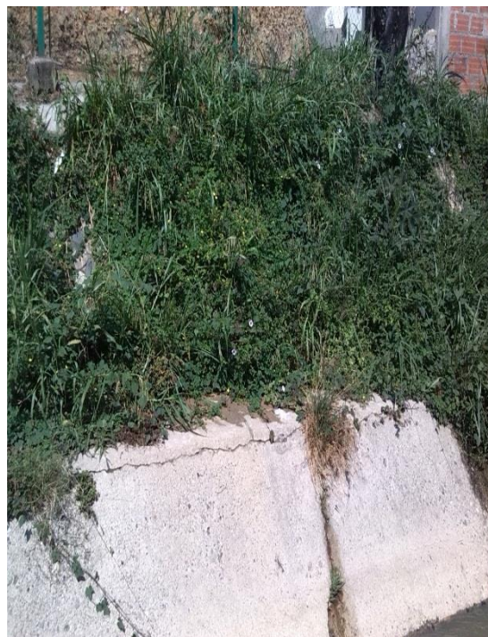
Figura 4. Vegetación, deficiencia de las juntas.
