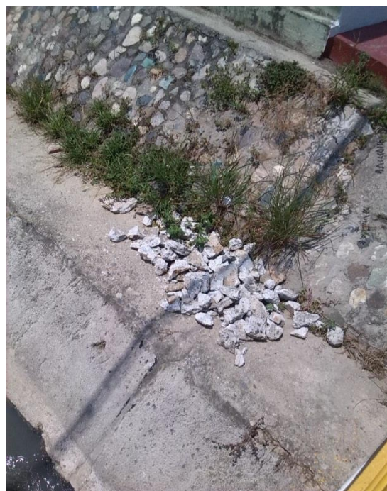
Figura 19. Obstrucción material rocoso en B2, desgaste del revestimiento.
