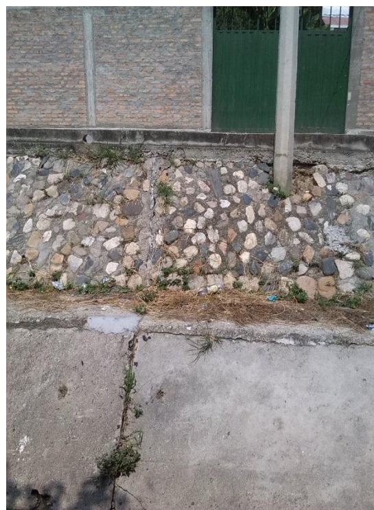
Figura 44. Daño e invasión del talud T2
