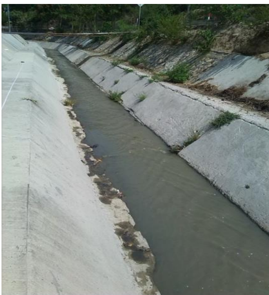
Figura 70. Margen izquierdo en buen estado, margen derecho con daños.
