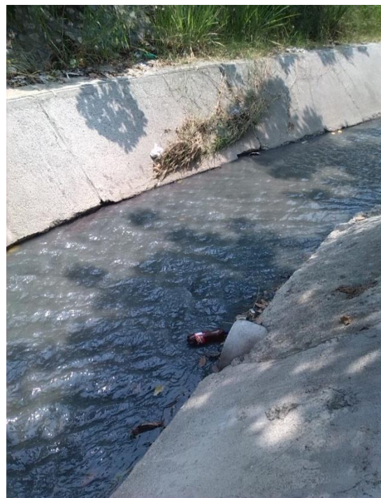
Figura 102. Socavación en ambos márgenes de la curva.
