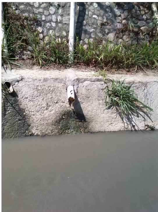
Figura 7. Conexión domiciliaria, vegetación, desgaste del revestimiento.
