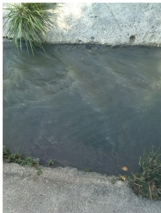
Figura 21. Vegetación, Desgaste de revestimiento Socavación.
