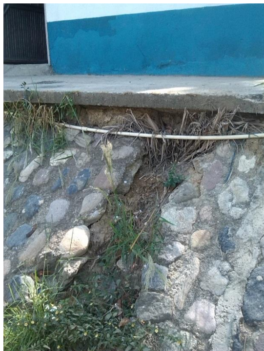
Figura 39. Discontinuidad en T2
