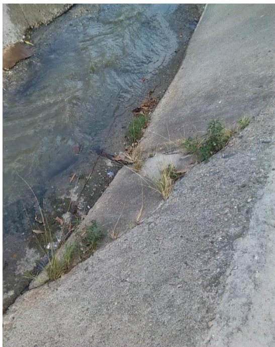
Figura 48. Agrietamiento en losa, desgaste de revestimiento y asentamiento en la base.
