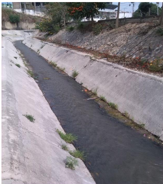
Figura 74. Socavación entre la base y T1, margen izquierdo. Vegetación de ambos márgenes.
