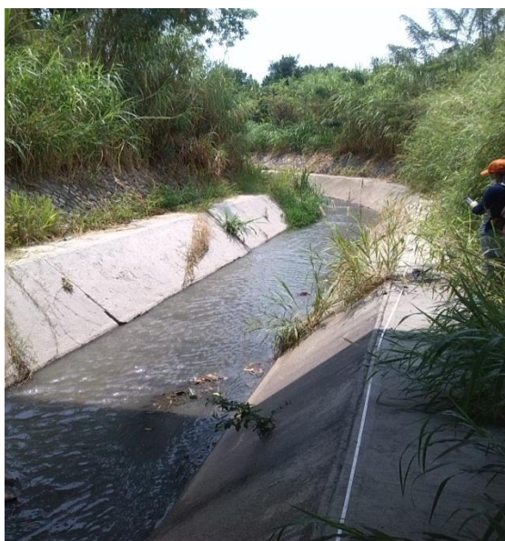
Figura 95. Basura y sedimentación en socavación y deficiencia en el sello de las juntas.
