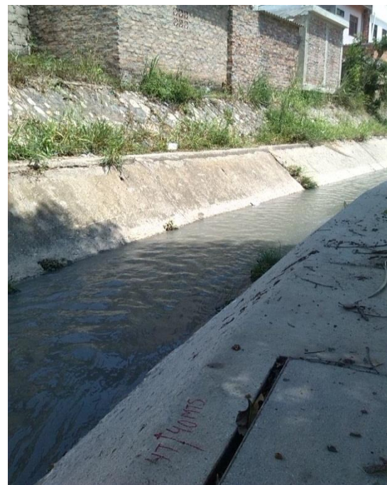
Figura 17. Desgaste de revestimiento y juntas, vegetación margen izquierdo.
