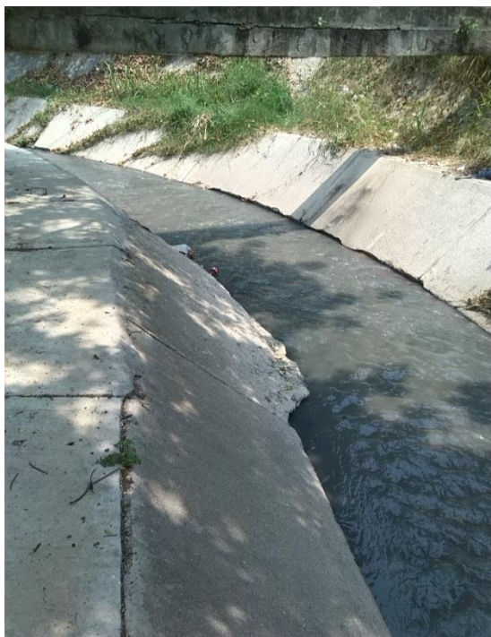
Figura 101. Abultamiento en el revestimiento de T1 del margen izquierdo.
