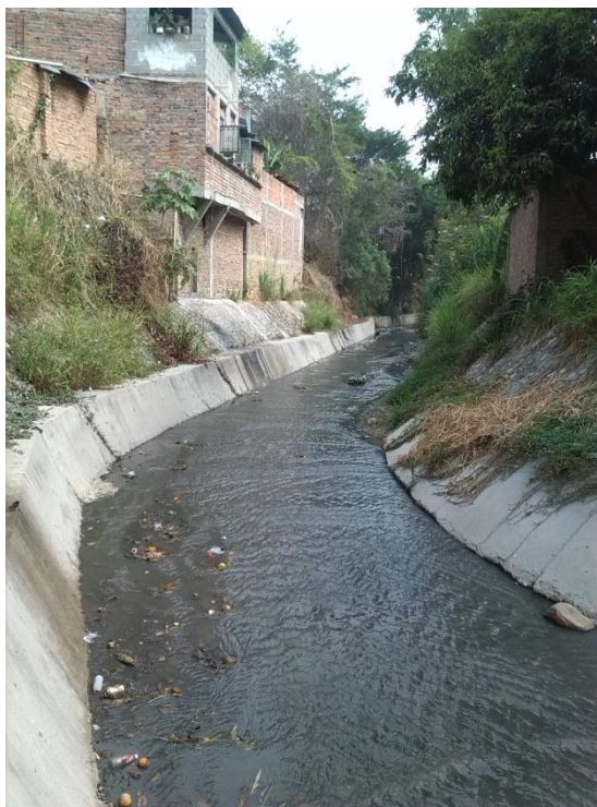
Figura 109. Margen derecho con presencia de socavación.
