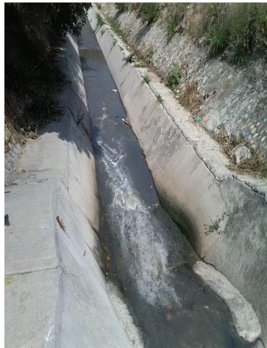
Figura 61. Perdida del sello en Juntas.
