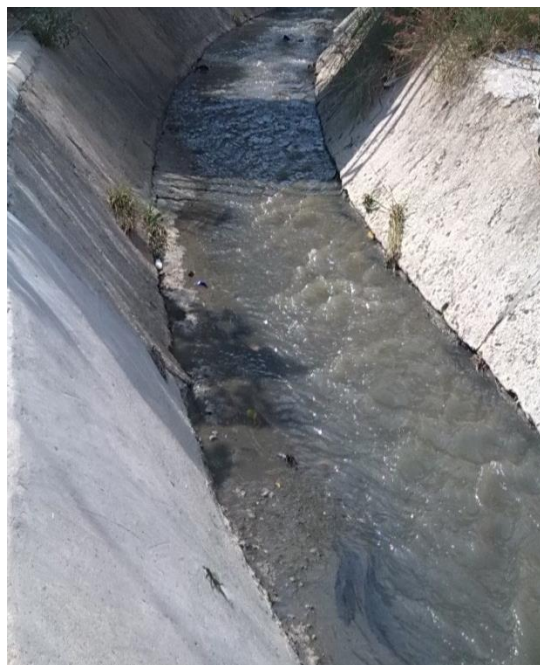
Figura 31. Socavación, desgaste de revestimiento en margen izquierdo.
