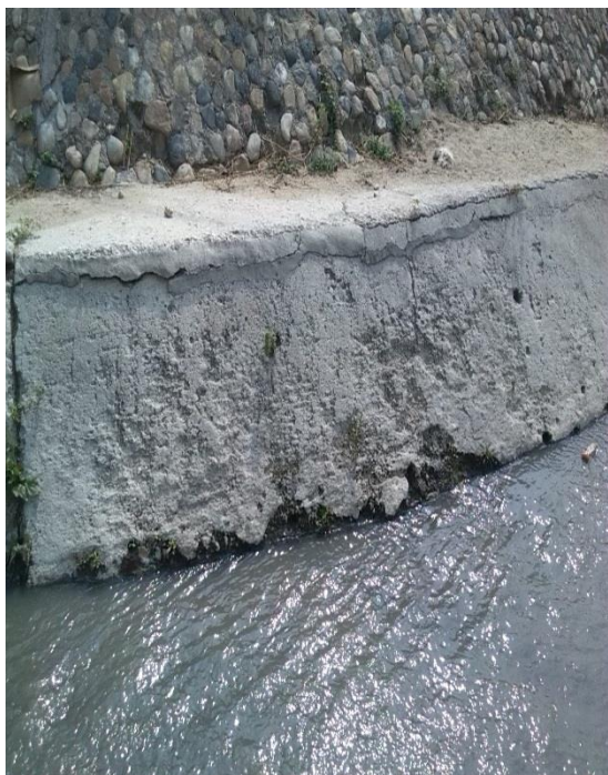
Figura 77. Desgaste del material de revestimiento y socavación
