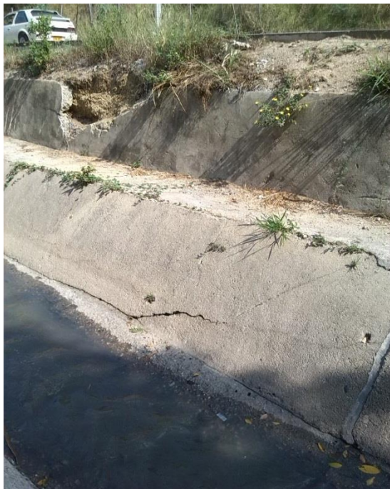
Figura 60. Grieta en losa del talud T1 margen derecho.
