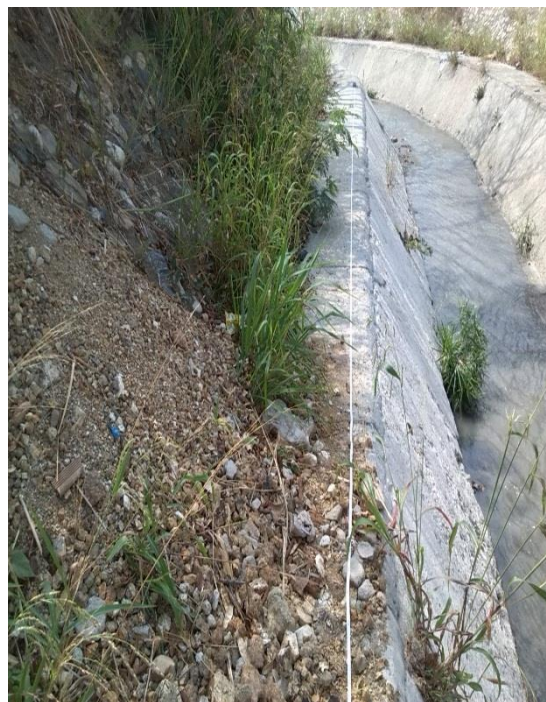
Figura 35. Obstrucción y vegetación.
