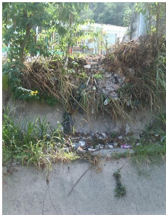
Figura 53. Basura y vegetación en el margen derecho.
