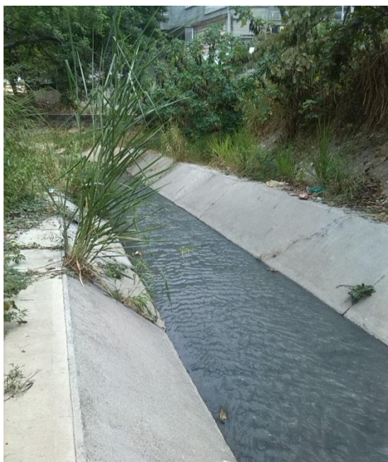
Figura 103. Deficiencia de juntas
