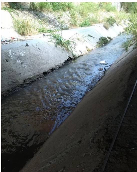
Figura 50. Socavación y desgaste ambos márgenes.
