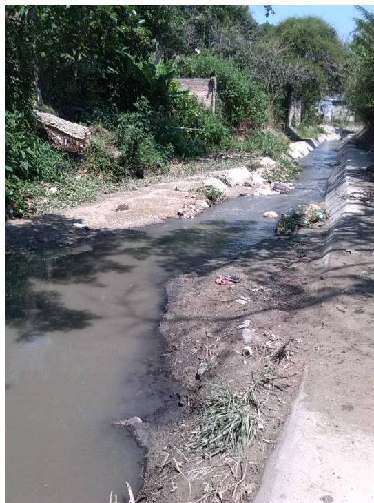
Figura 11. Sedimentación, perdida estructura margen izquierdo.
