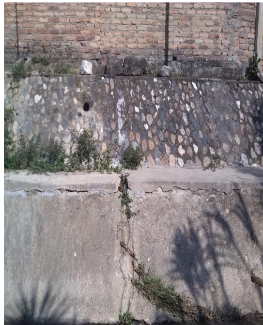
Figura 29. Deficiencia de las juntas, desgaste el revestimiento, socavación.
