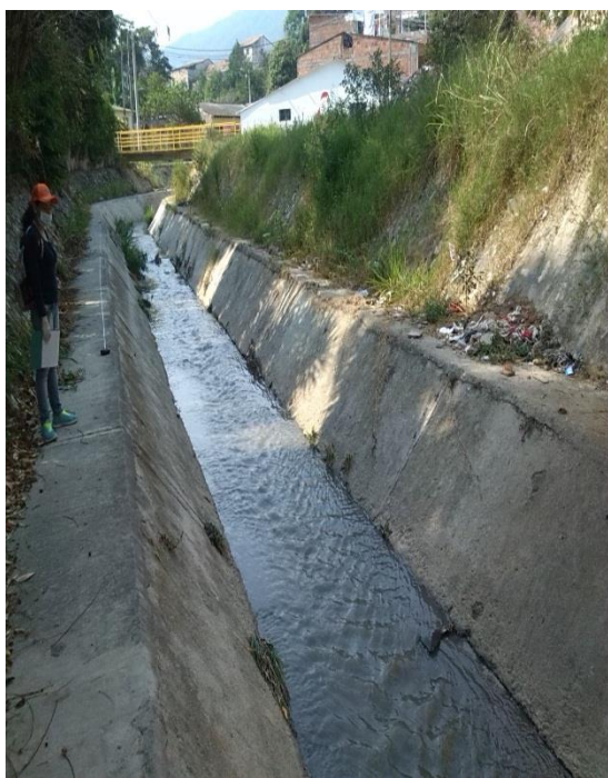
Figura 24. Residuos sólidos, y desgaste de revestimiento.
