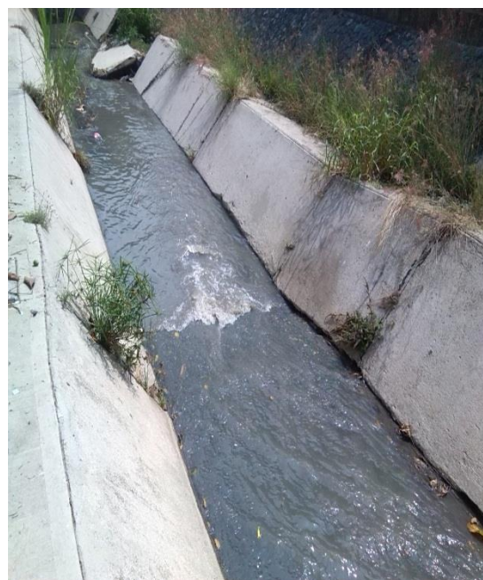
Figura 87.Socavación entre B y T1 ambos de márgenes.
