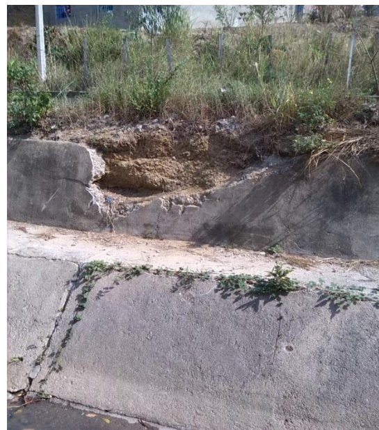
Figura 63. Perdida del talud T2 en el margen derecho
