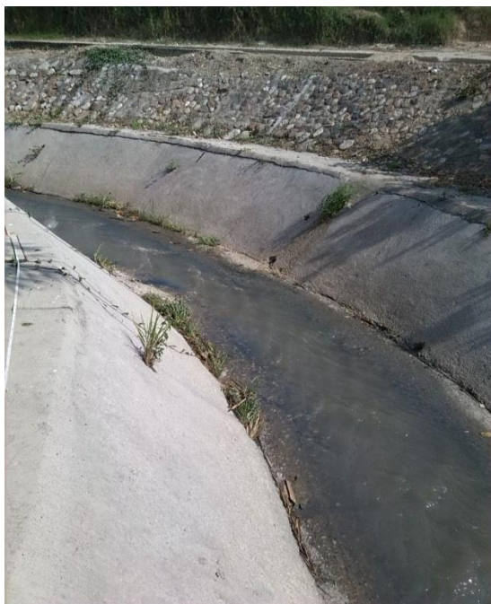
Figura 58. Deficiencia en juntas y revestimiento.
