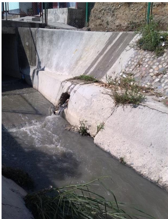
Figura 3. Desgaste revestimiento, vegetación, conexión errada.
