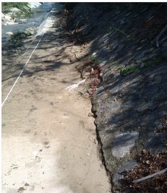
Figura 12. Socavación entre B2 y T2.
