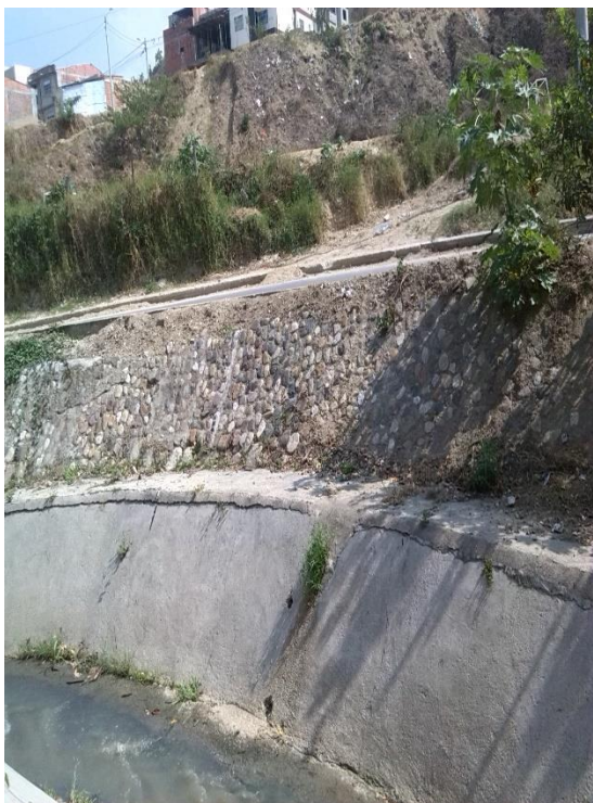
Figura 56. Deficiencia en juntas.
