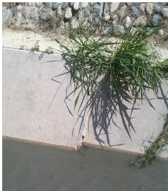
Figura 65. Levantamiento de losa y vegetación.
