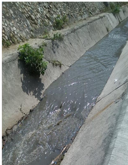
Figura 67. Desgaste de deficiencia revestimiento
