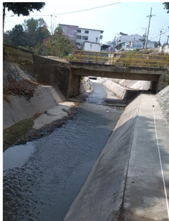
Figura 82. Sección de gran amplitud, solo daños de erosión de juntas.
