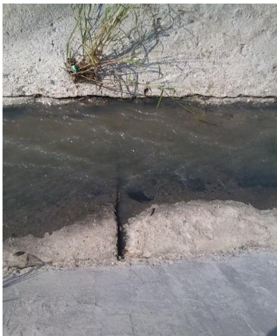
Figura 32. Desplazamiento de junta, desgaste margen izquierdo.
