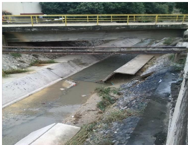
Figura 2. Avance 1, daño tramo 24
