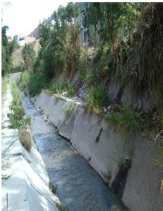
Figura 52. Exceso de vegetación y basura del margen derecho.
