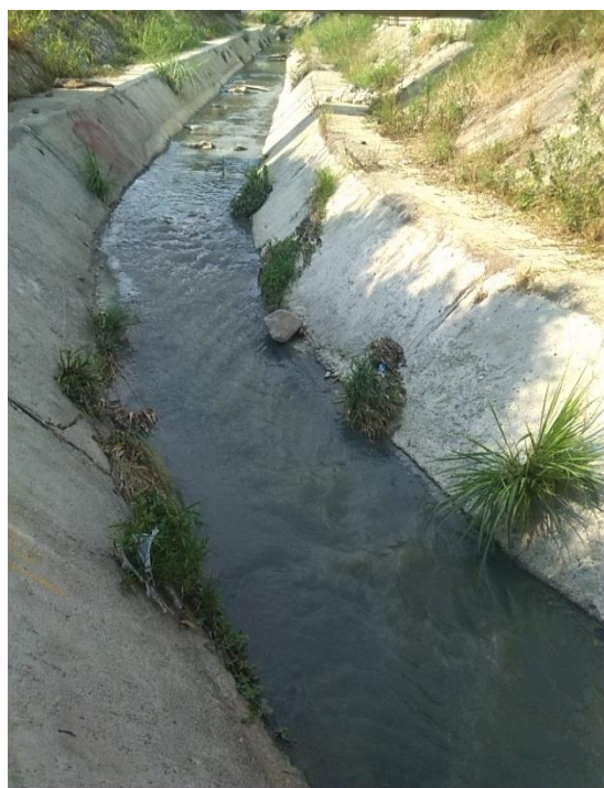
Figura 20. Desgaste del revestimiento, vegetación, grietas.
