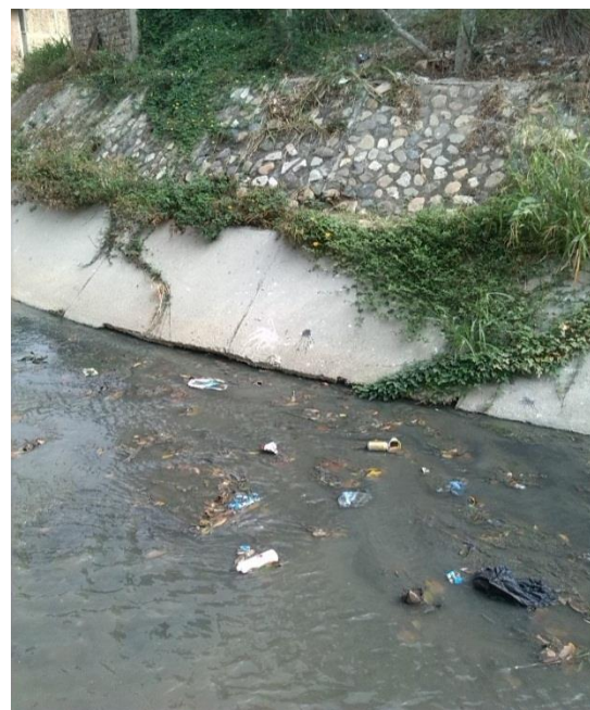
Figura 108. Socavación en la losa del margen derecho. Vegetación sedimentos y basura.
