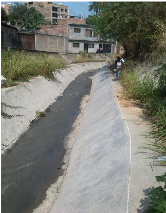
Figura 34. Socavación en las juntas margen izquierdo, vegetación ambos márgenes.
