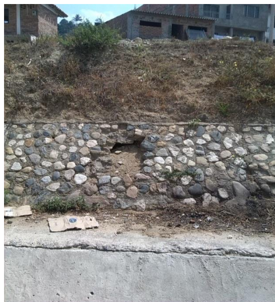
Figura 71. Ruptura del material de revestimiento de T2, deficiencia en juntas.
