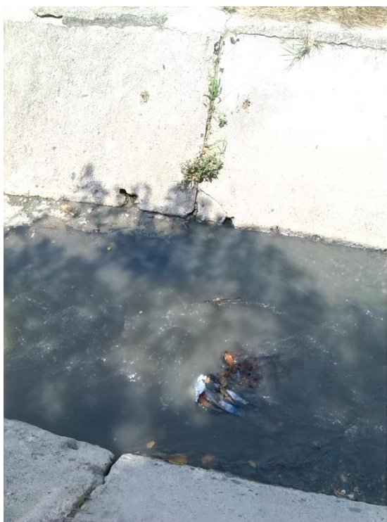
Figura 41. Socavación ambos Márgenes y deficiencia en juntas
