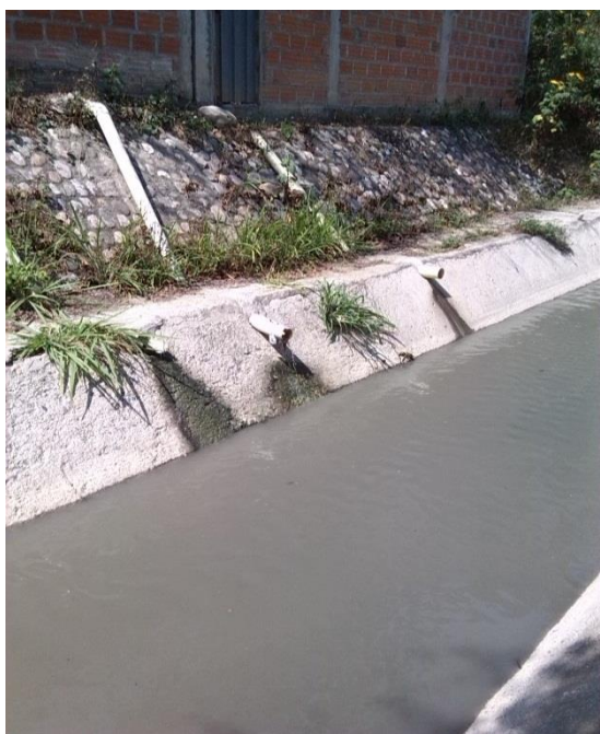
Figura 8. Conexión domiciliaria, desgaste del revestimiento. Fuente: Autores (2016).
