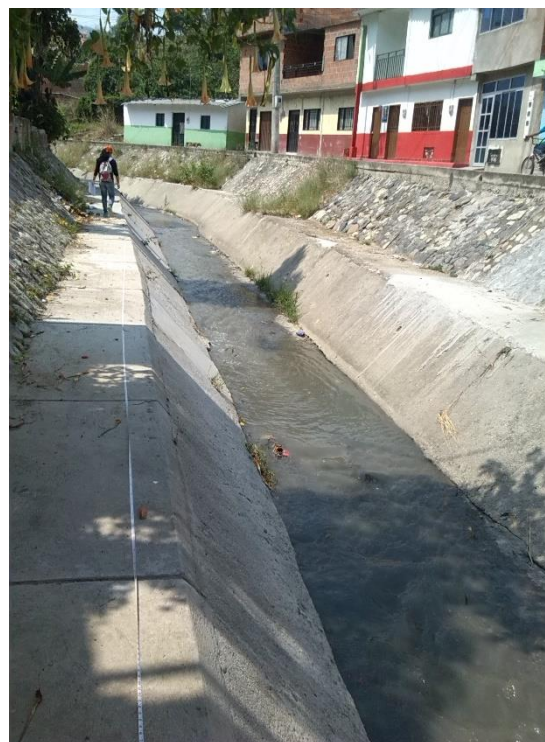
Figura 42. Erosión en el revestimiento, poca vegetación.
