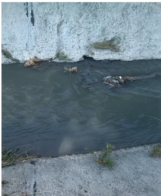
Figura 30. Socavación, desgaste del Revestimiento.
