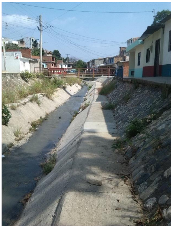
Figura 38. Desgaste del revestimiento
