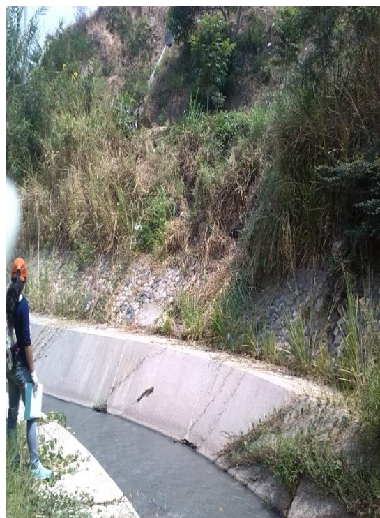
Figura 89.Socavación y deficiencia juntas, vegetación.
