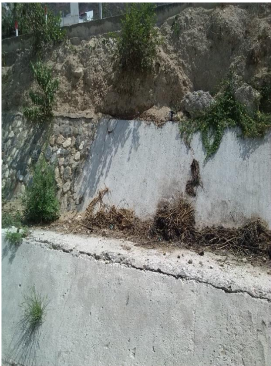
Figura 68. Deficiencia en juntas y pérdida del sello.
