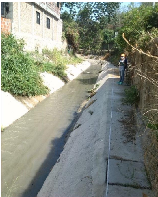
Figura 5. Desgaste de revestimiento, socavación, vegetación.
