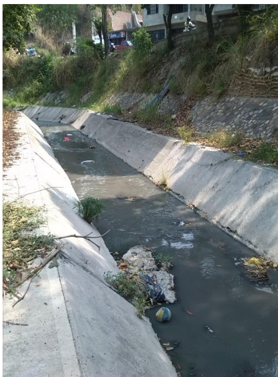
Figura 88.Obstrucción en el canal de material de concreto, sedimentos y basura.
