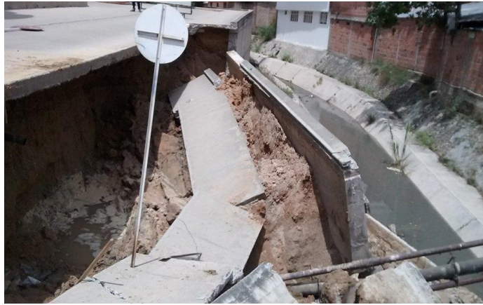
Figura 3. Colapso del muro de contención
