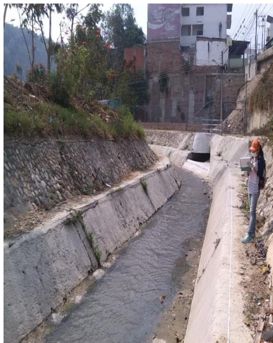
Figura 78. deterioro margen derecho.
