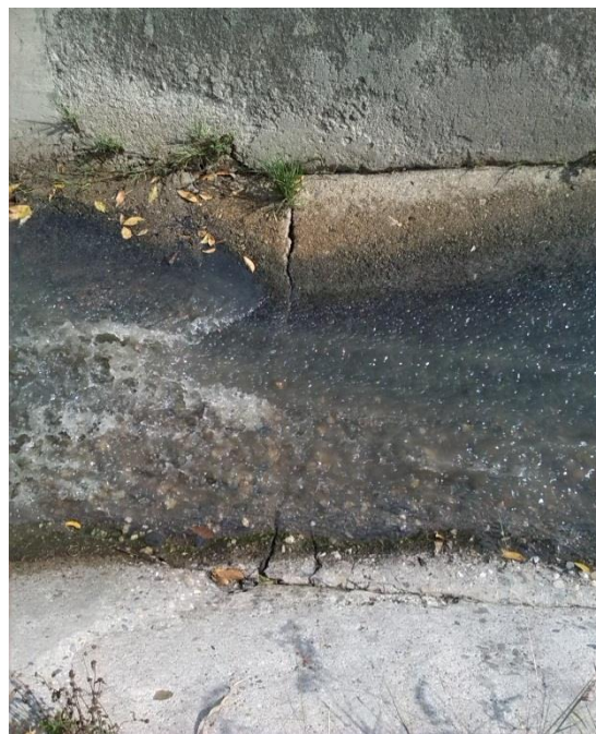
Figura 59. Asentamiento y desgaste de la base.
