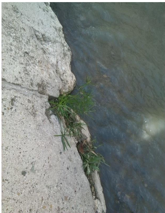
Figura 26. Socavación de talud, desgaste de revestimiento.
