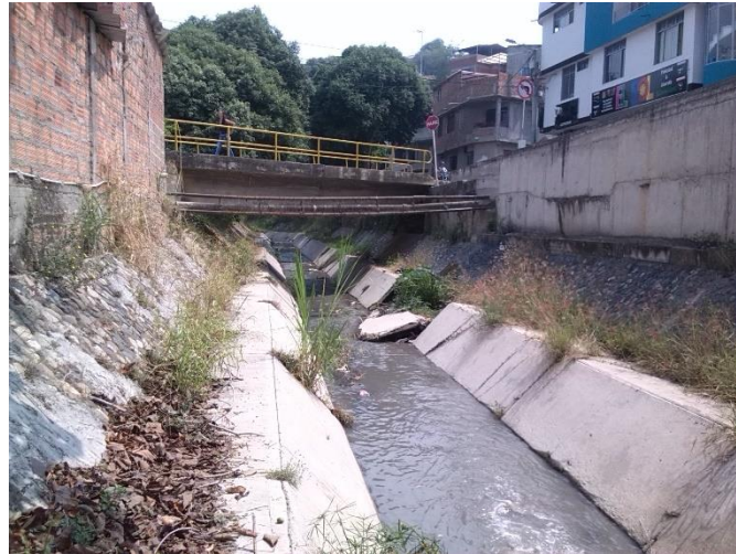
Figura 1. Daño del margen derecho tramo 24
