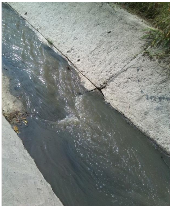
Figura 36. Desgaste de revestimiento asentamiento de la base.
