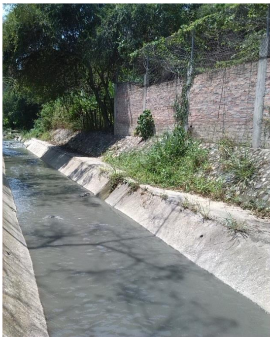
Figura 14. Vegetación margen izquierdo, desgaste en juntas margen izquierdo.
