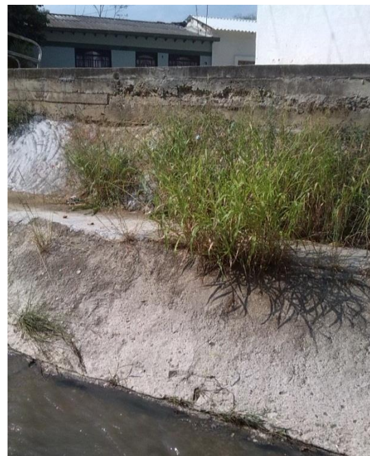
Figura 33. Socavación entre, desgaste de revestimiento, presencia de vegetación.
