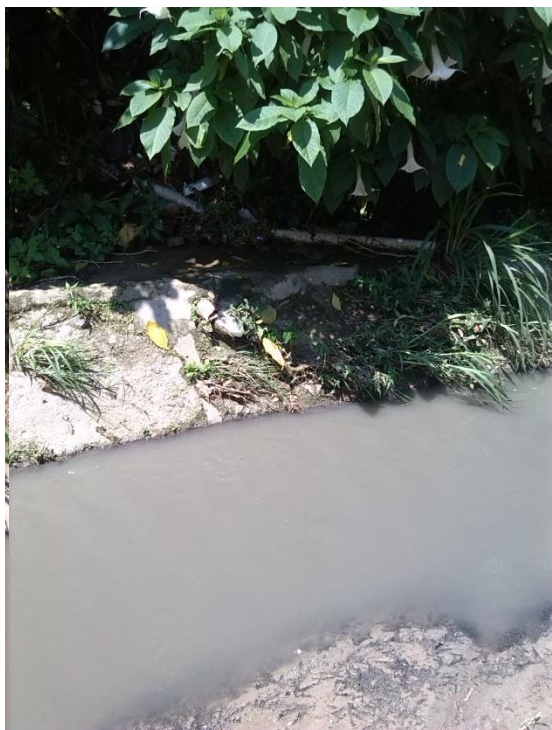
Figura 10. Perdida de la estructura, vegetación.
