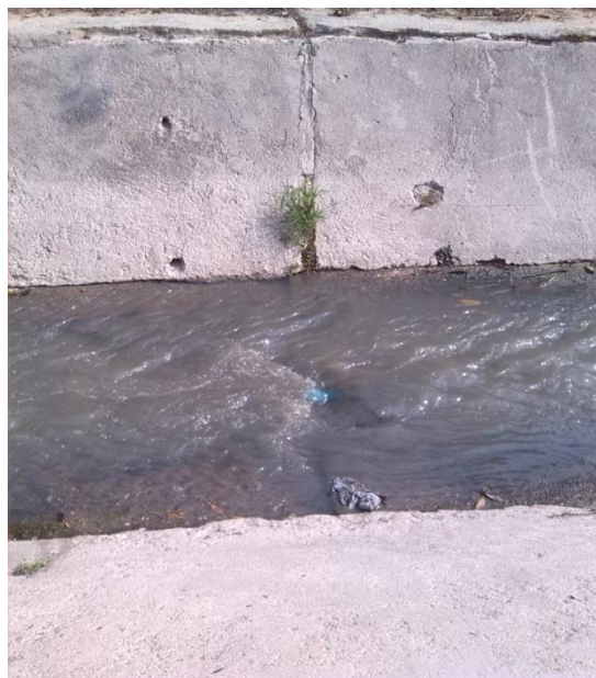
Figura 75. Asentamiento de la base agrietamientos de losas, separación de Juntas y socavación.
