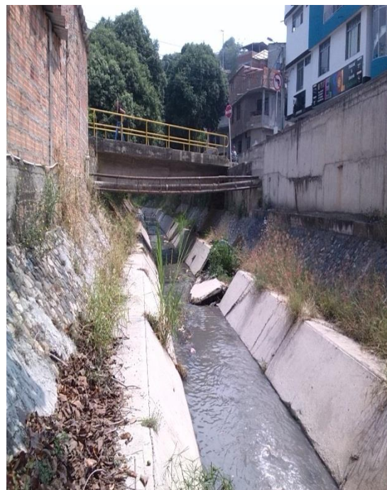
Figura 85.Perdida de sección en T1 del margen derecho, presencia de vegetación.
