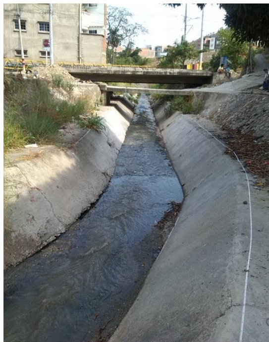
Figura 49. Socavación entre B y T1 margen izquierdo, desgaste de revestimiento.
