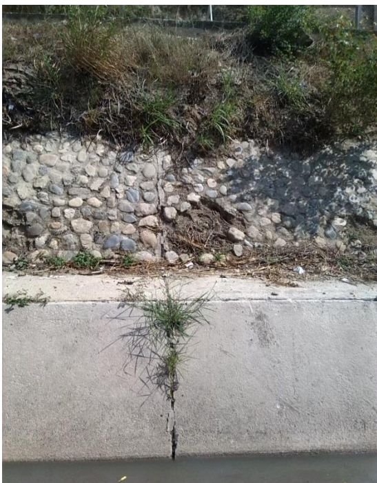
Figura 66. Perdida de revestimiento y en las juntas.
