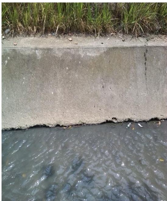
Figura 99. Socavación a lo largo del tramo en el margen derecho.
