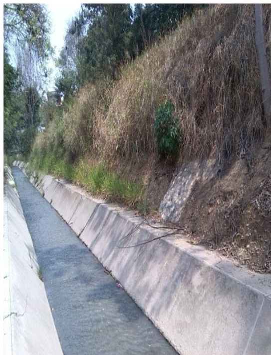
Figura 98. Derrumbe de material arcilloso depositado en T2 y B2 del margen derecho.
