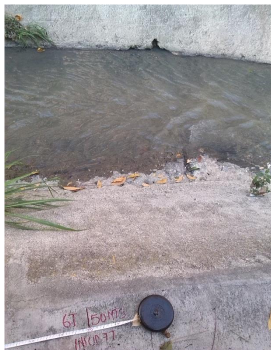
Figura 25. Socavación, desgaste de revestimiento.
