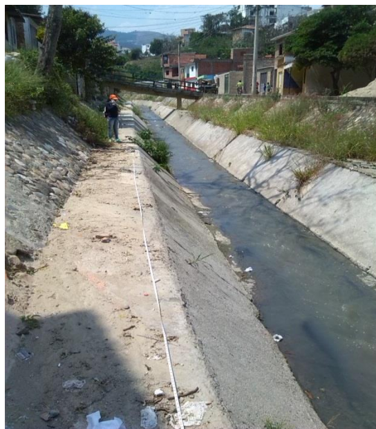
Figura 46. Asentamiento en base del canal
