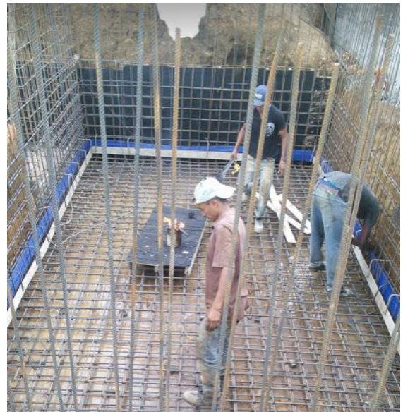
Fotografía 32. Acero cuarto de bombas
