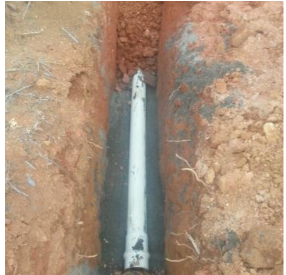
Fotografía 36. Tubería PVC presión
