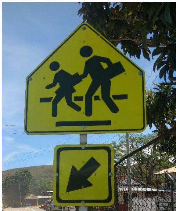
Figura 27. Señal preventiva 47a en buen estado, ruta 7008.
