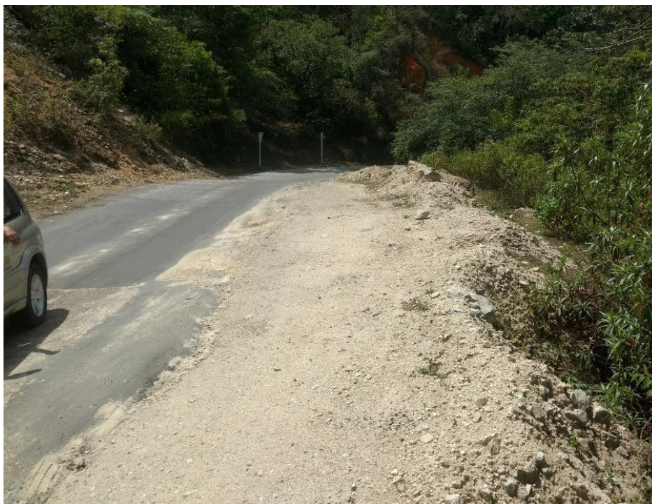
Figura 40. Paso tramo pérdida de banca, PR 55+900.
