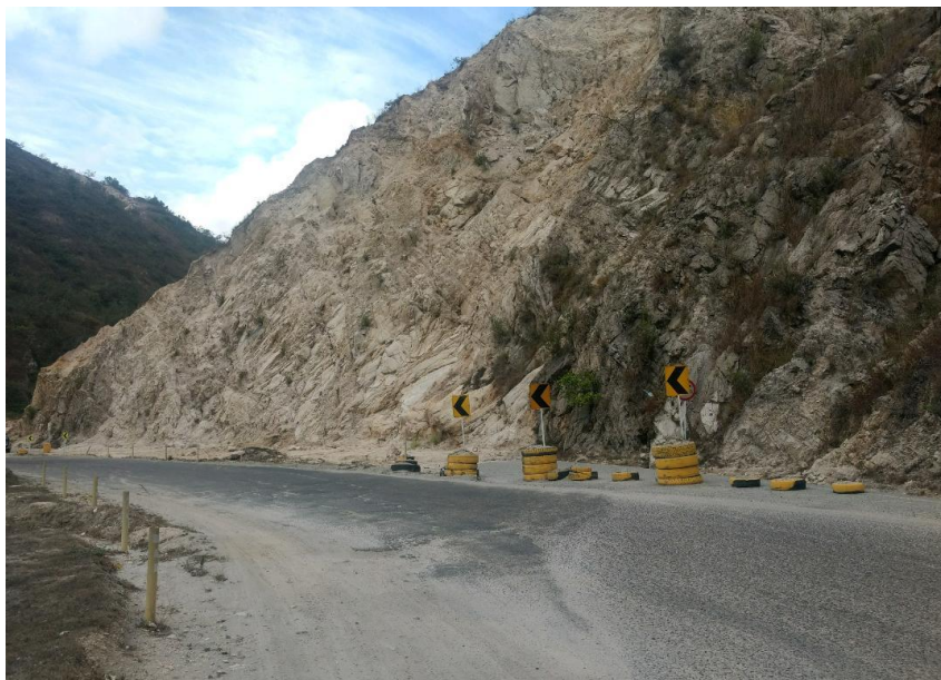
Figura 39. Paso tramo de derrumbe, PR11+700.
