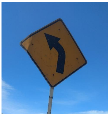
Figura 28. Señal preventiva en regular estado, hendidura en la lámina.
