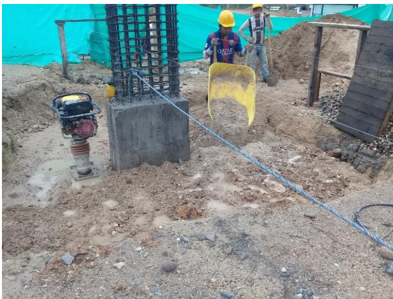
Figura 45. Retraso en el relleno y compactación debido a lluvias.
