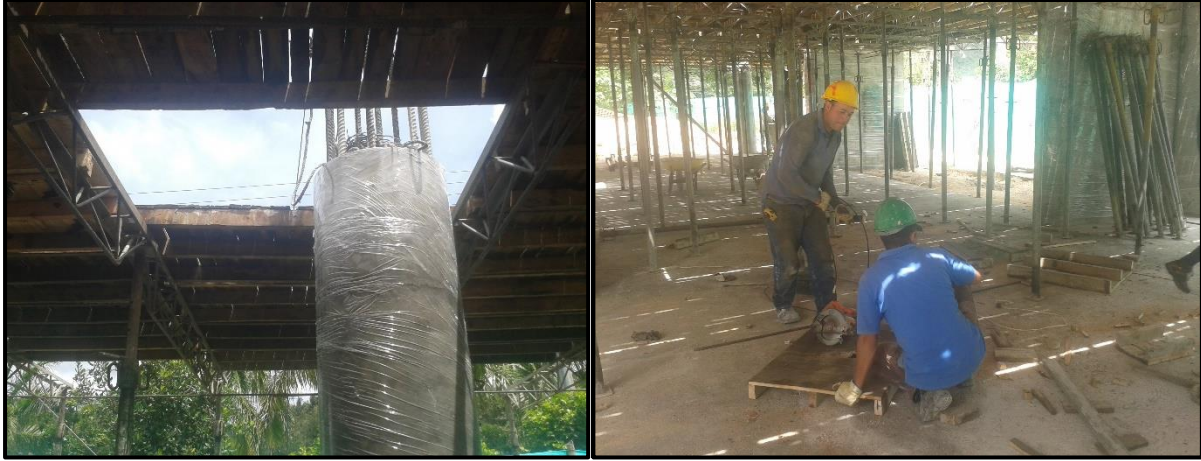
Fotografía 56. Corte e instalación de los tableros en el área de las columnas.
