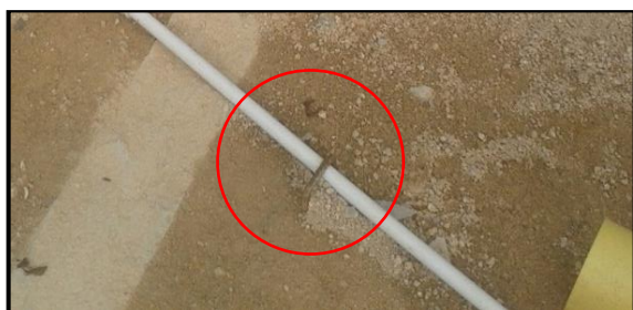
Fotografía 41. Punto de anclaje de la tubería hidráulica.
